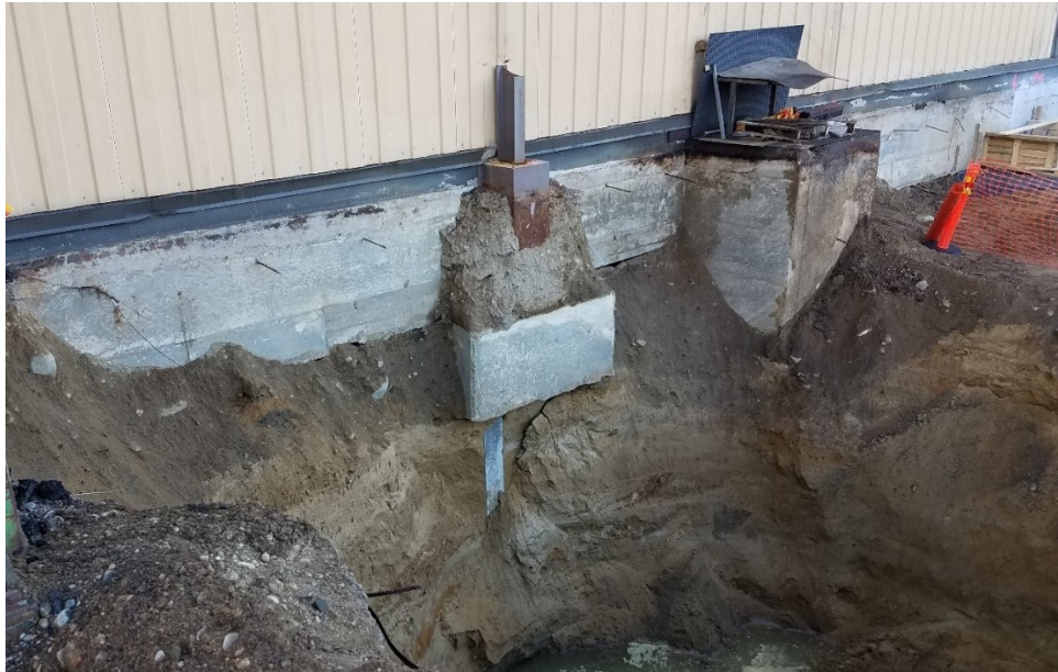
Kuva 12. Hallin pilarit tulivat kaivuussa esille eikä kaivuuta voitu ulottaa syvemmälle tehdasrakennuksen alle. Kunnostuksen jälkeen kuopan pohjalle ja hallin vastaiselle sivulle asennettiin bentoniittimatto. (Meri Helmi, 2018)
