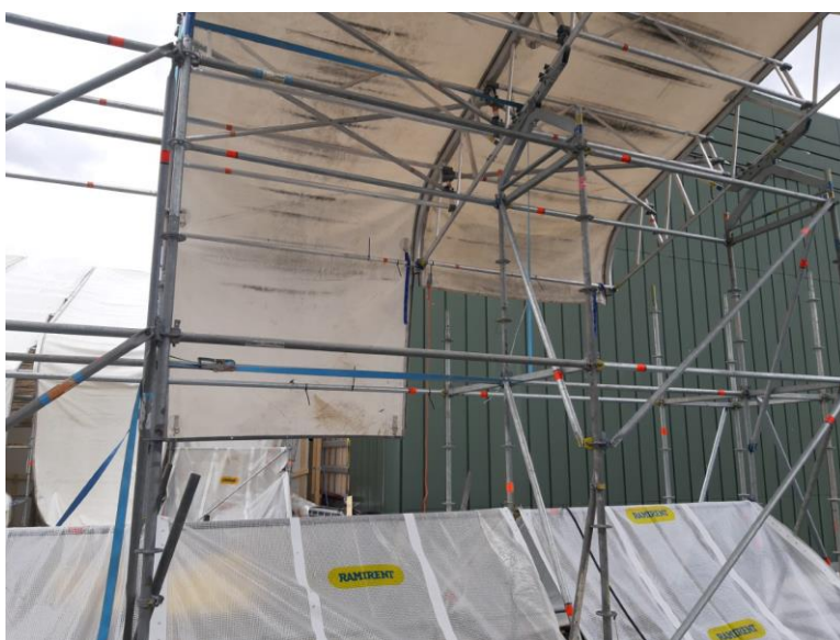
Kuva 5. Haapaveden Valion korjauskohde
