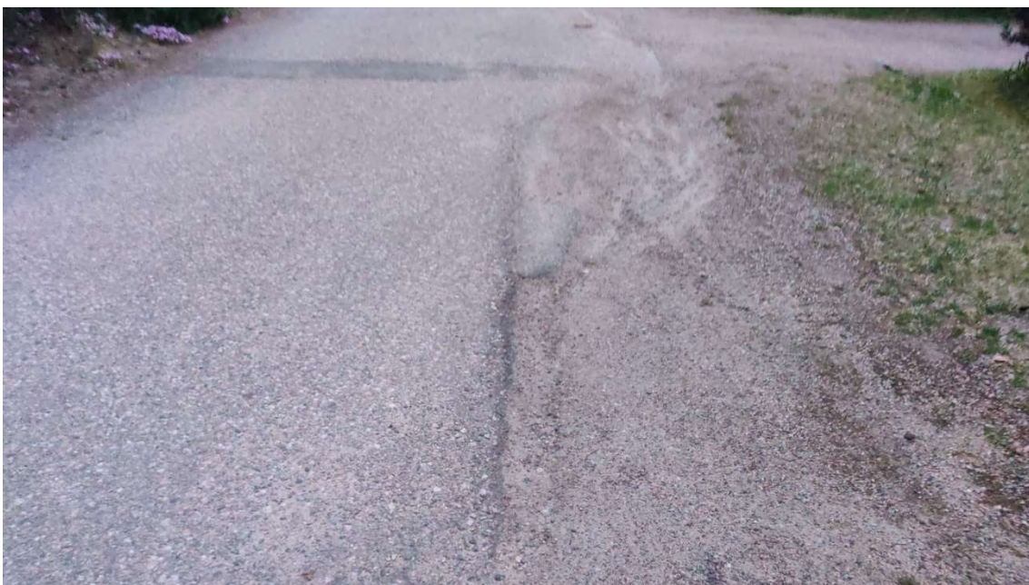
Kuva 59 Leveä pitkittäshalkeama Paloasemantien päällysteessä
