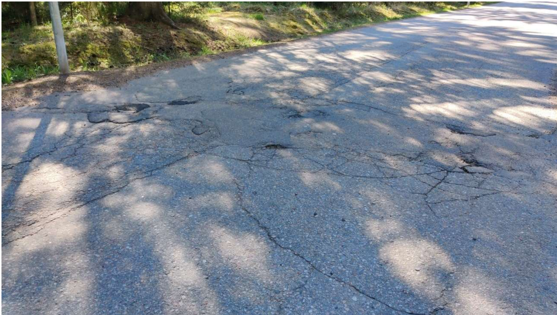
Kuva 28 Painauma ja päällysteen reikiintymistä Kirkkomäentiellä
