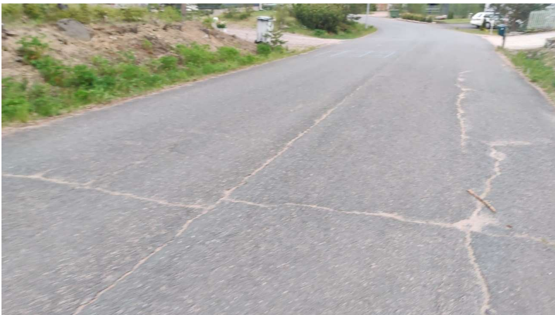
Kuva 50 Verkkohalkeama Kangasvuokontien päällysteessä
