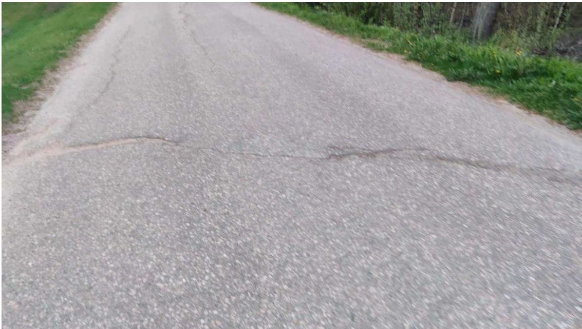
Kuva 47 Poikittaishalkeama Kallentien päällysteessä
