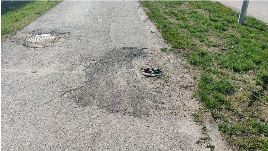
Kuva 25 Painauma Koulutien JK/PP:n päällysteessä
