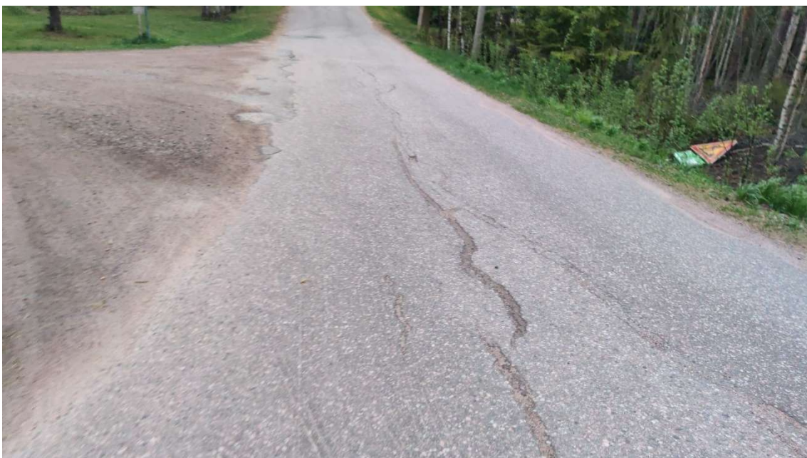
Kuva 46 Pitkittäishalkeamia Kallentien päällysteessä
