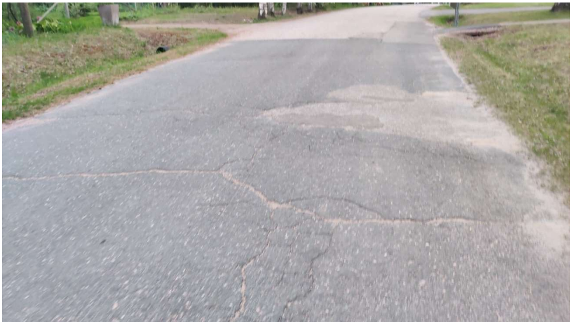
Kuva 56 Halkeamia ja painauma Kekomäentien pahemmin vaurioituneella osuudella
