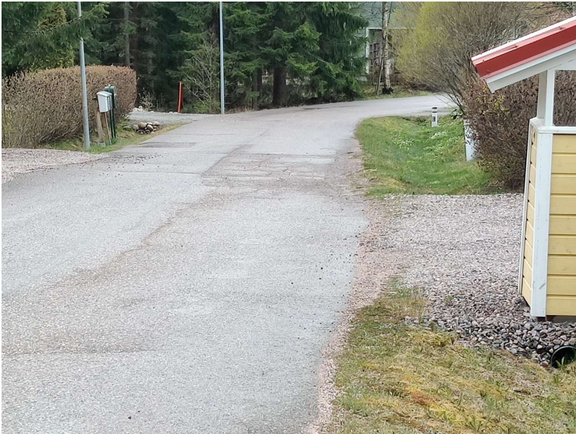
Kuva 67 Vaurioita Sahratien päällysteessä
