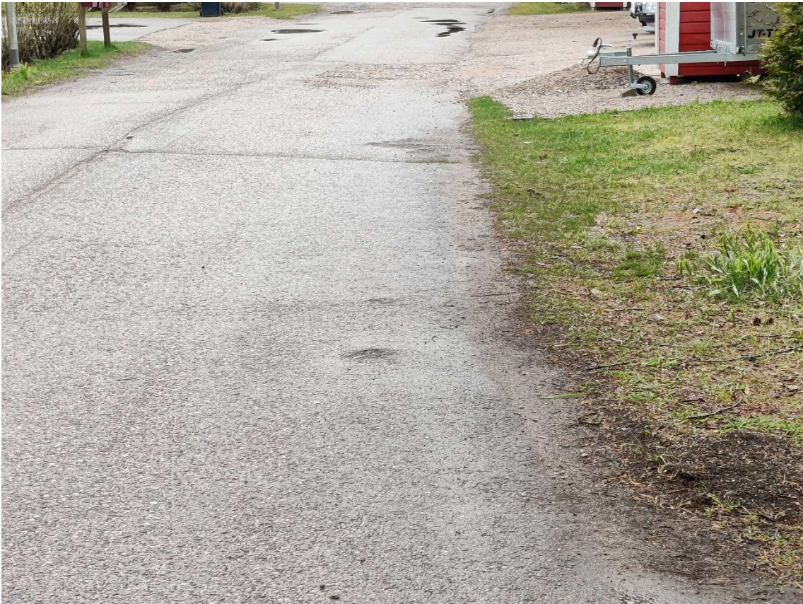
Kuva 66 Vaurioita Itutien päällysteessä
