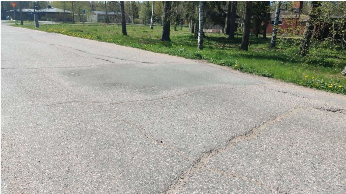
Kuva 13 Epätasaisuutta ja halkeamia Ryttyläntiellä
