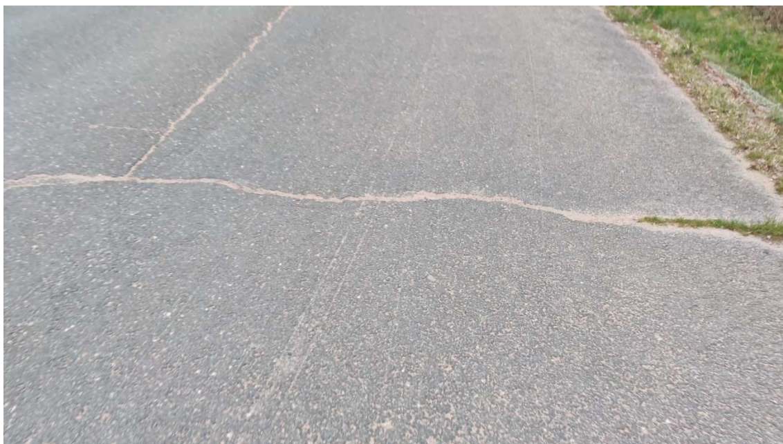
Kuva 51 Pitkittäis- ja poikittaishalkeama Kangasvuokontien päällysteessä
