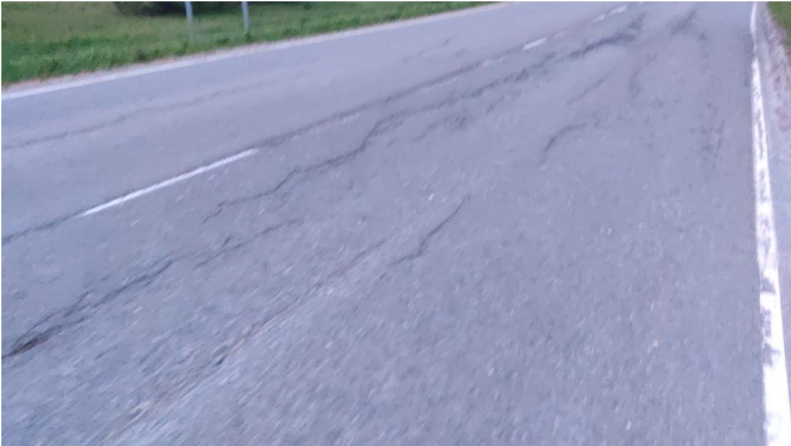
Kuva 43 Useita pitkittäshalkeamia seututien 290 päällysteessä
