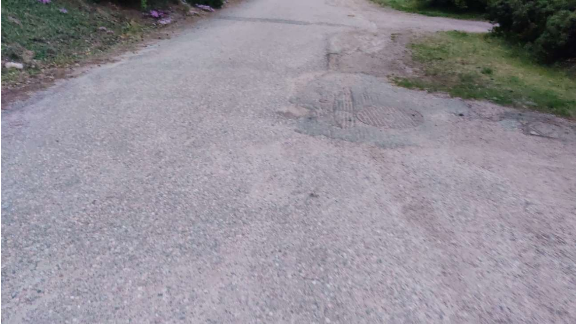
Kuva 61 Painauma ja halkeamia Paloasemantiellä
