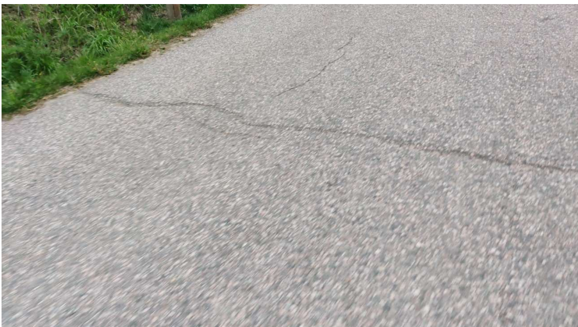
Kuva 55 Pieni poikittaishalkeama Kekomäentien päällysteessä
