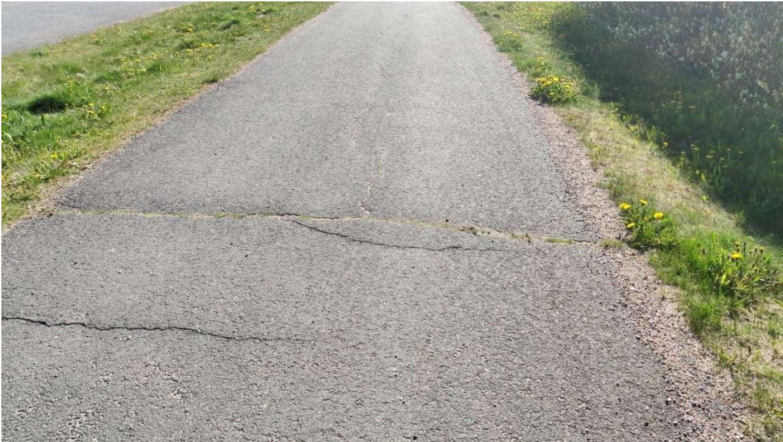
Kuva 35 Poikittaishalkeama Eteläkaaren JK/PP:llä
