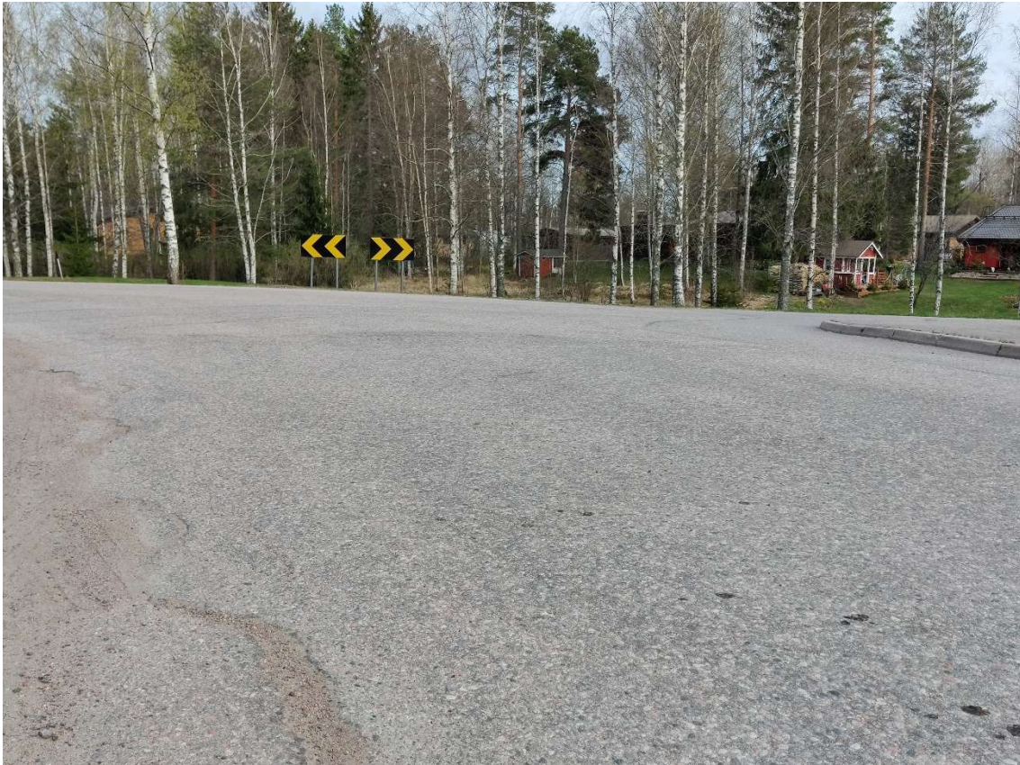
Kuva 38 Kohouma ja pitkittäshalkeamia Vanhalla kylätiellä
