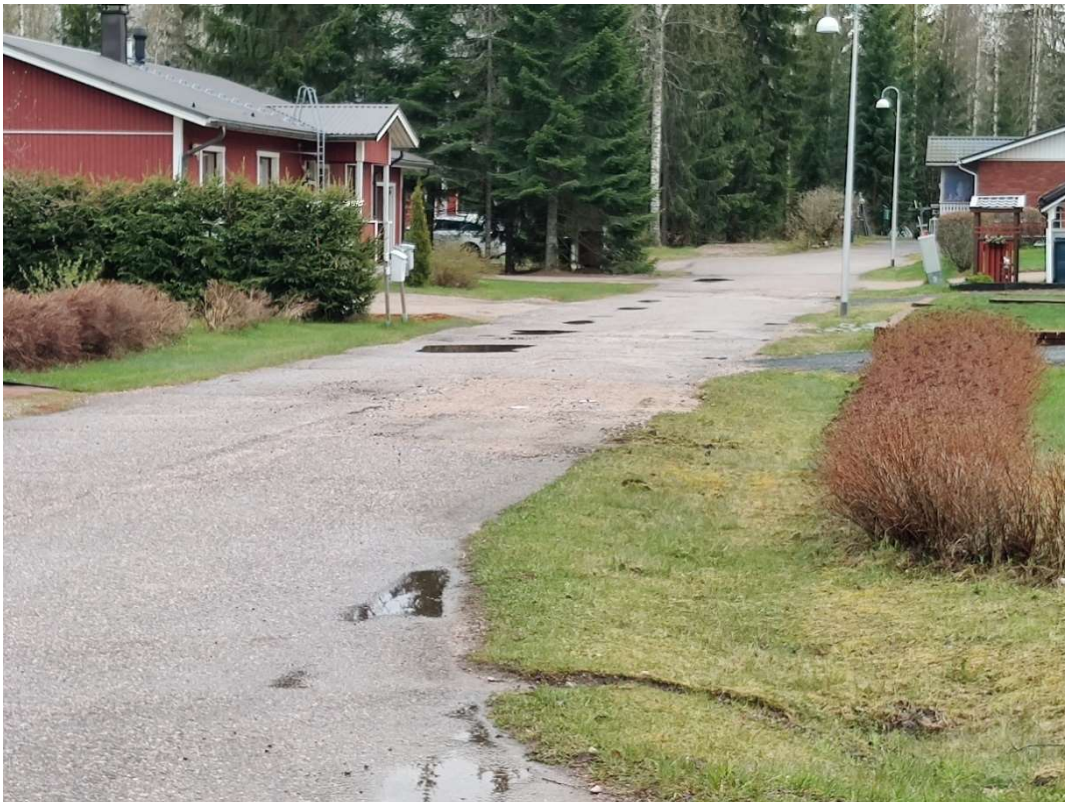
Kuva 64 Reikä ja painaumia Perunakuopantien päällysteessä.
