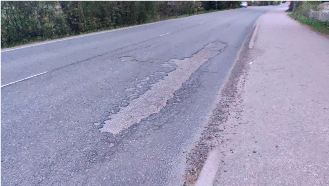
Kuva 41 Suuri reikä seututien 290 päällysteessä
