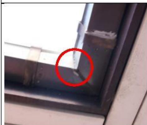
24. Vuotokohta kourun sisätaiteessa.
