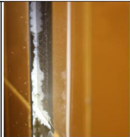
40. Peilikaapin ja seinän väliin syntynyttä vaahtomaista kalkkeutumaa.
