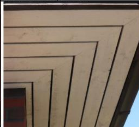
12. Lähes uudenveroinen räystääsaluslaudoitus.
