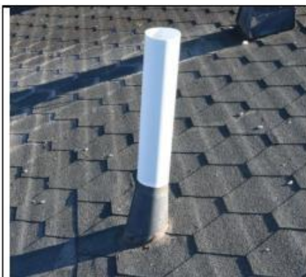
22. Viemärin tuuletusputken hattu puuttuu.
