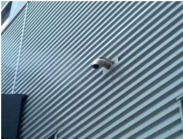
Kuva 23. Vuotohöyryn ja tyhjiöpumppujen ulospuhallus
