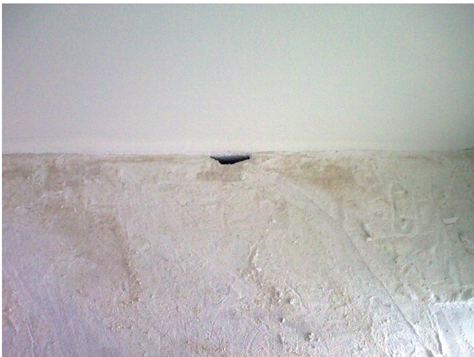
KUVA 11. Reikä eristetilaan solumuovikaistaleen, lattian pintalaatan ja seinärakenteen välissä.
