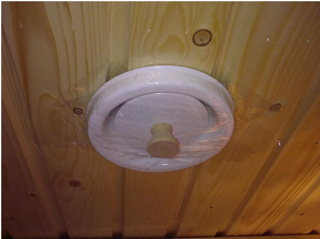
KUVA 17. Teipattu saunan tuloilmaventtiili.
