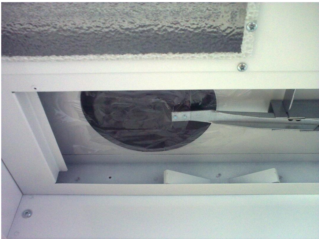
KUVA 19. Teipattu liesituulettimen poistokanava.
