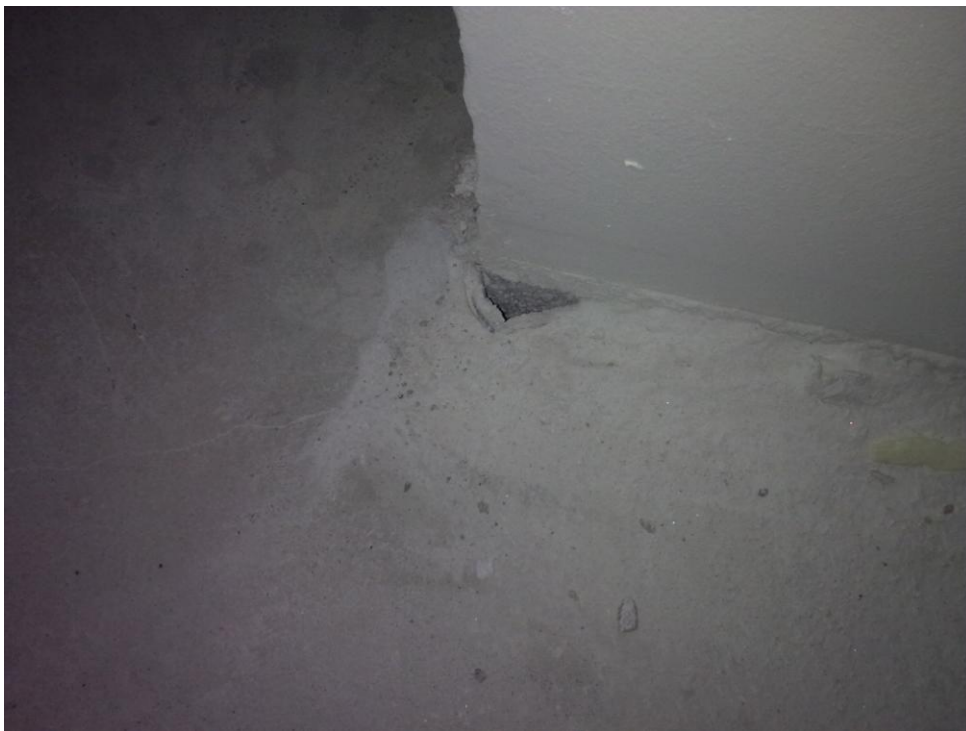
KUVA 10. Reikä eristetilaan solumuovikaistaleen, lattian pintalaatan ja seinärakenteen välissä.
