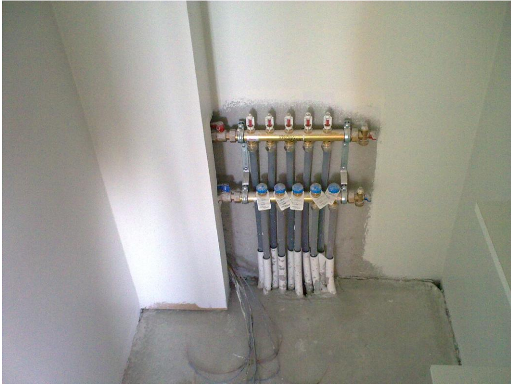
KUVA 13. Lattialämmitysputkien ylöstulossa sekä pintalaatan reuna-alueella on rakennuksen sisäisiä ilmavuotoja.
