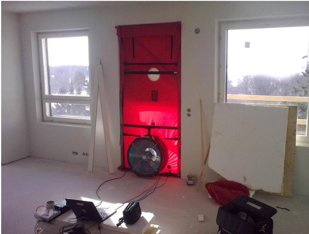
KUVA 5. Minneapolis BlowerDoor-laitteisto asennettuna huoneiston parveke oveen.
