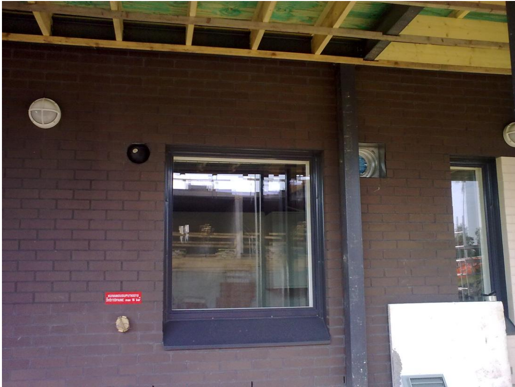
KUVA 22. Tulo- ja poistoilmakanavat tulpattuina.
