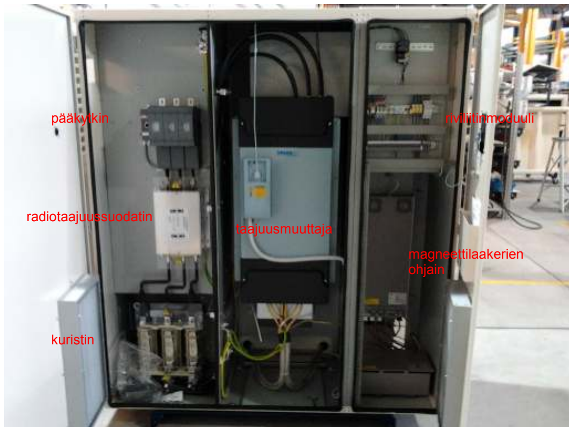
Kuva 6.3 Kokoonpantu HST6000-tyyppin sähkökaappi
