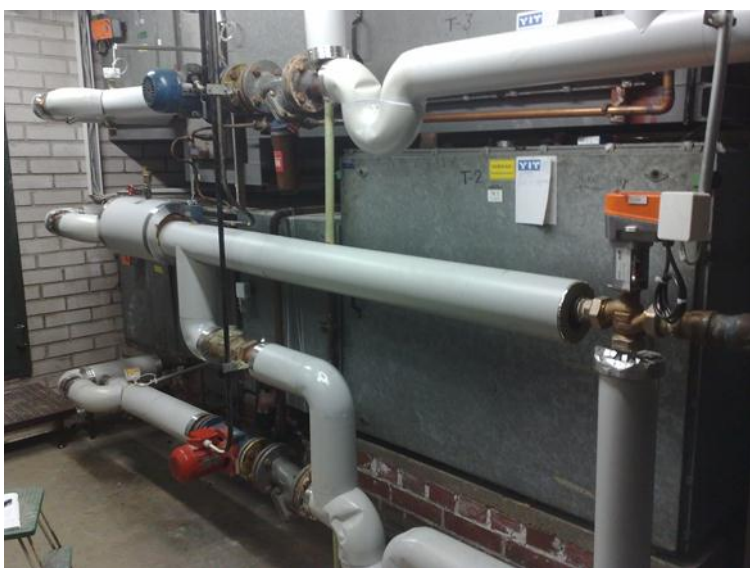
Kuva 1. Ilmastointikoneet TK-2 ja TK-3
