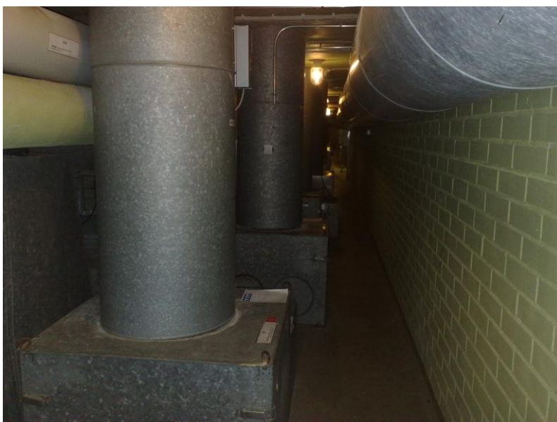
Kuva 2. Poistoilmakanavia vieri vieressä.
