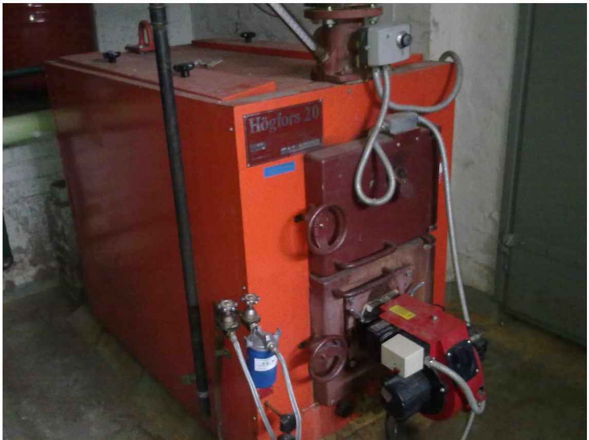
Kuva 1. Öljykattila ja poltin
