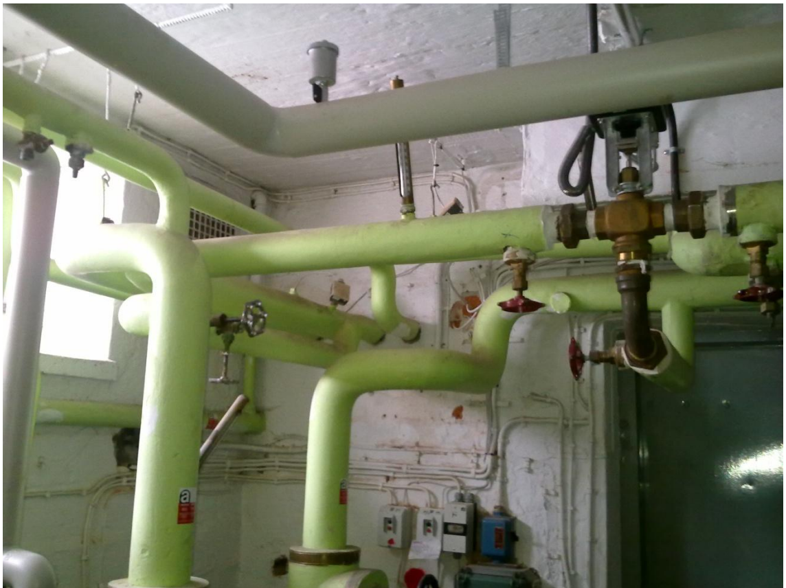
Kuva 2. Yleisnäkymä kattilahuoneen putkistoista
