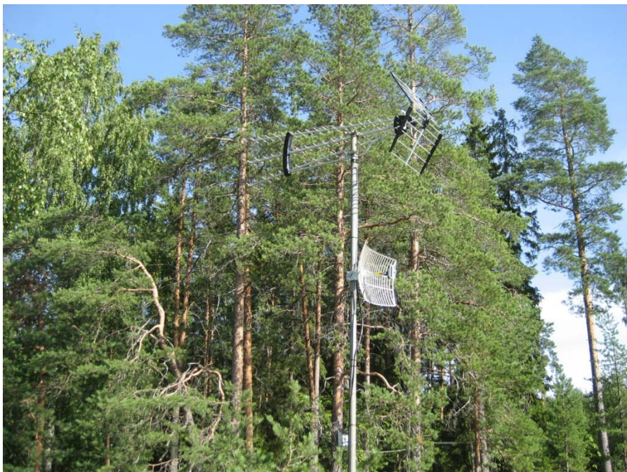
KUVA 8. 3G-antenni kiinnitettynä mastoputkeen (Kuva: Lassi Rautiainen 2011)
