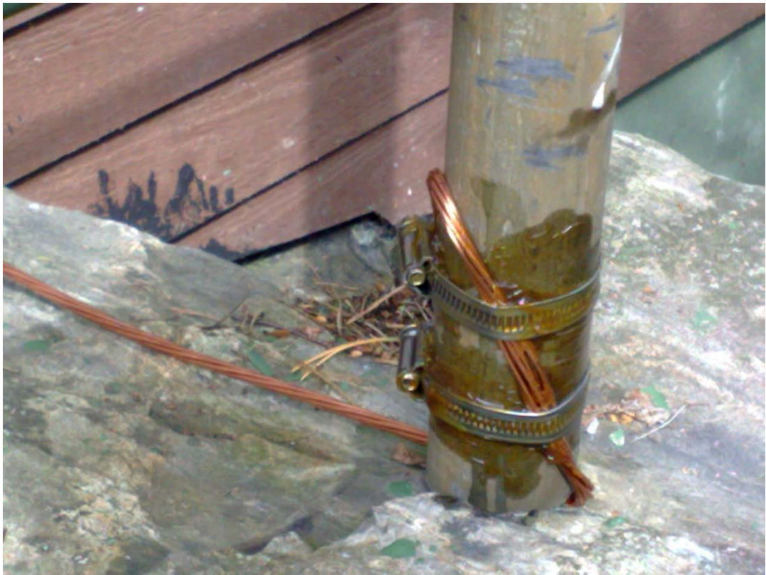
KUVA 6. Mastoputken ukkosmaadoitus (Kuva: Lassi Rautiainen 2011)
