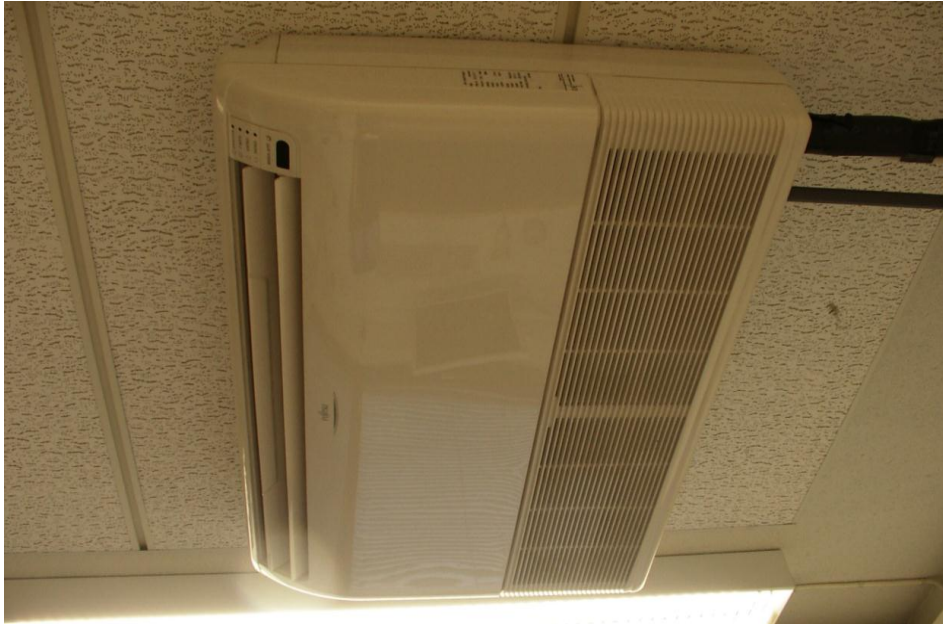
KUVA 14. Tutkimuskohteena ollut kattomallinen ilmalämpöpumppu. (Bergman 2011)
