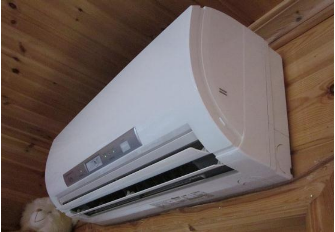
KUVA 1. Ilmalämpöpumpun sisäyksikkö. (Bergman 2012)
