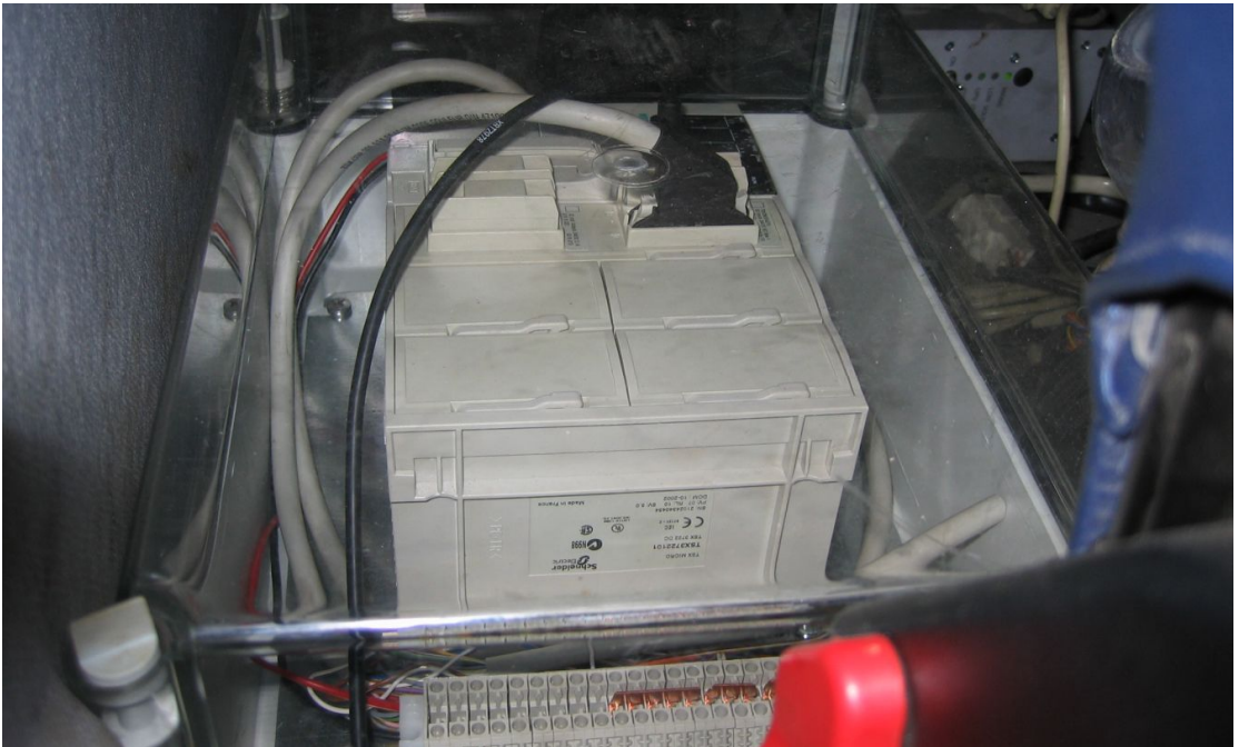
KUVIO 26. Logiikka asennettuna autoon.
