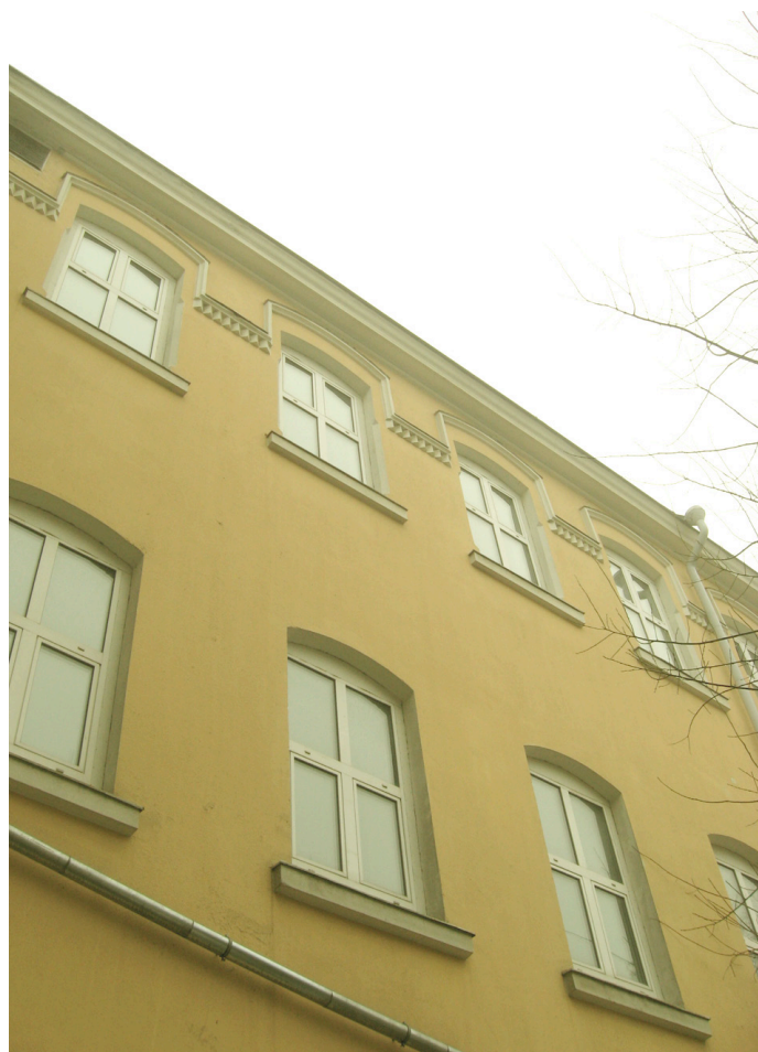
KUVA 122. Vanhan rakennuksen julkisivun kellertävä rappaus
