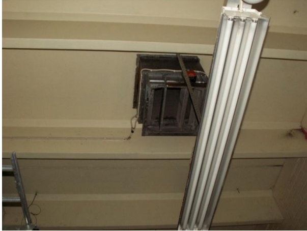
Kuva 74. viereisen sähköpääkeskuksen huippuimuri
