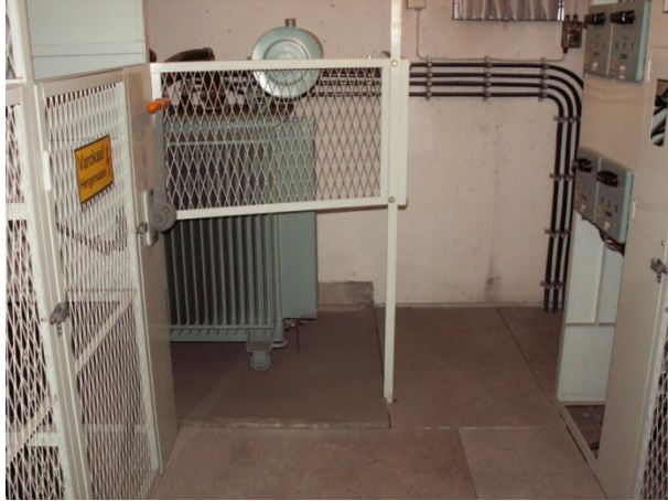
Kuva 57. Muuntaja betonialustan päällä
