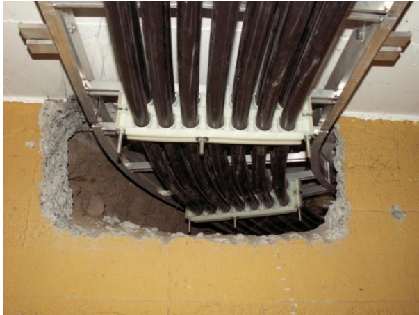
Kuva 65. Muuntamon seinän läpivienti
