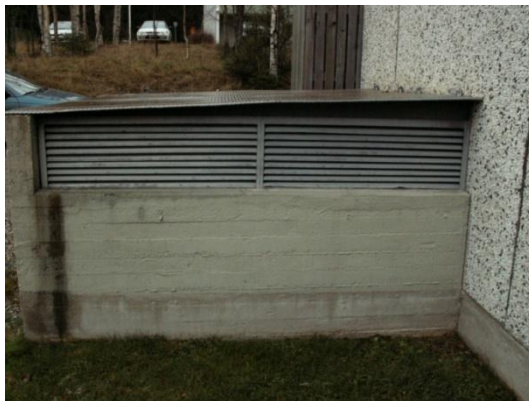
Kuva 77. Poistoilma-aukko ja muuntamon kuljetusreitti
