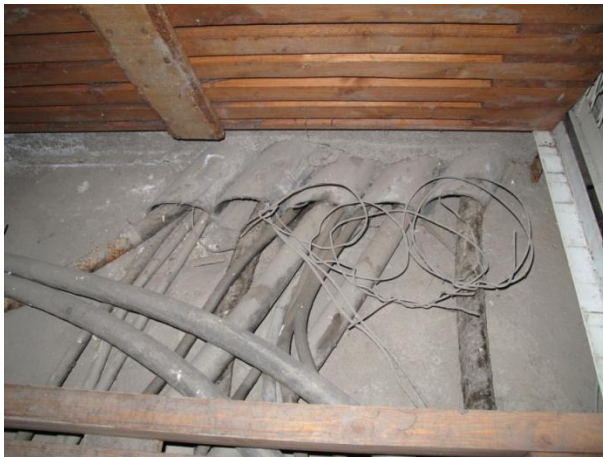
Kuva 47. Kaapeliläpiviennit korotetun lattian alla
