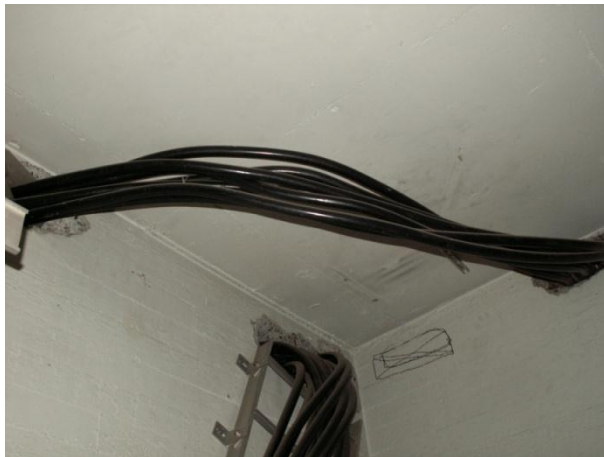
Kuva 14. Tilan läpi meneviä kaapeleita
