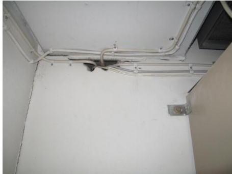
Kuva 98. Läpivienti viereiseen sähköpääkeskukseen
