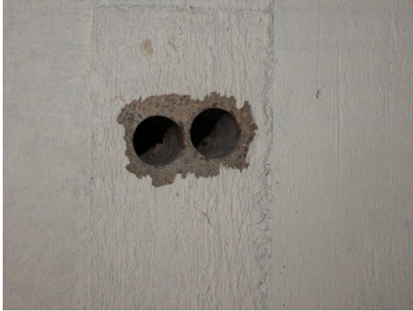
Kuva 24. Muuntamotilan katon reiät
