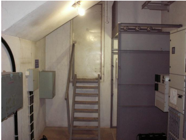
Kuva 18. Muuntamotilan puiset portaat
