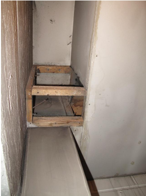
Kuva 49. Osa ylimääräisestä iv-kanavasta puuttuu
