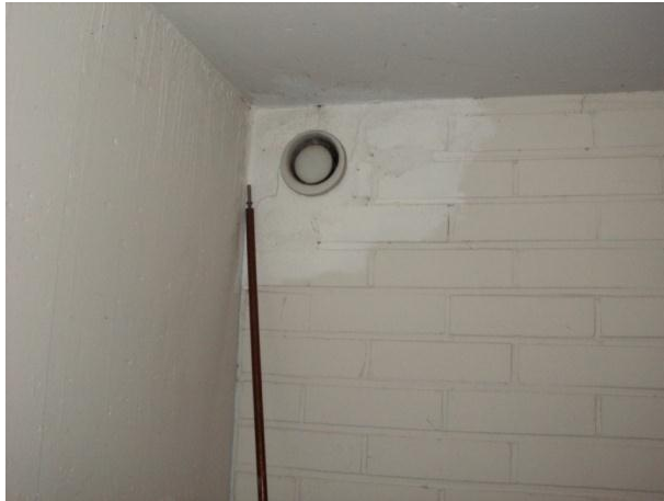
Kuva 32. Poistoilma-aukko talon yhteiseen ilmanvaihtoon
