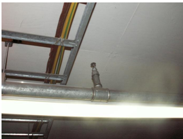
Kuva 94. Osa muuntamon sprinklerijärjestelmää
