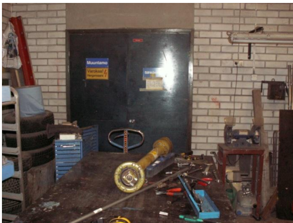
Kuva 80. Muuntamon edessä on paljon tavaraa
