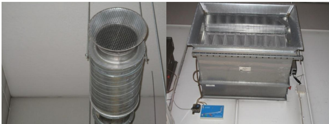
Kuva 102 ja 103. Muuntamon iv-kanavat
