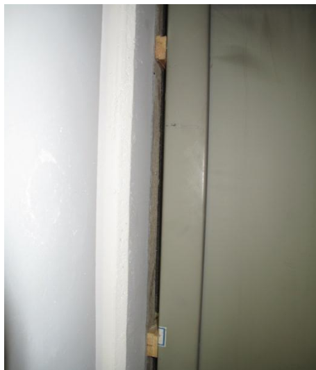
Kuva 99. Puutteellinen oven kiinnitys.
