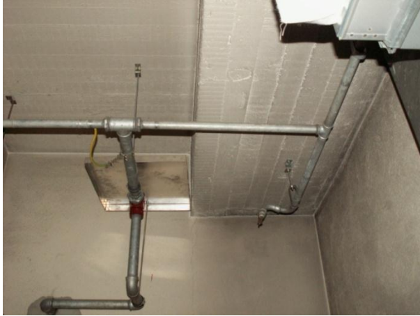
Kuva 43. Muuntajan yläpuolisia sprinklereitä
