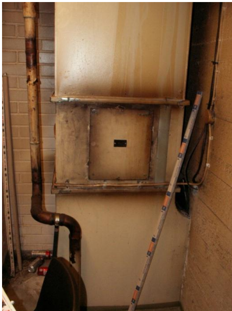
Kuva 16. Tuloilmakanava tulee viereisen tilan kautta
