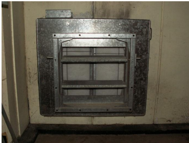
Kuva 73. Muuntamotilassa oleva tuloilma-aukko
