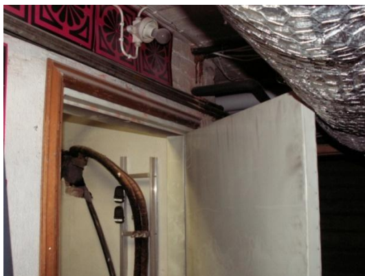
Kuva 8. Ilmanvaihtokanava tukkii oven
