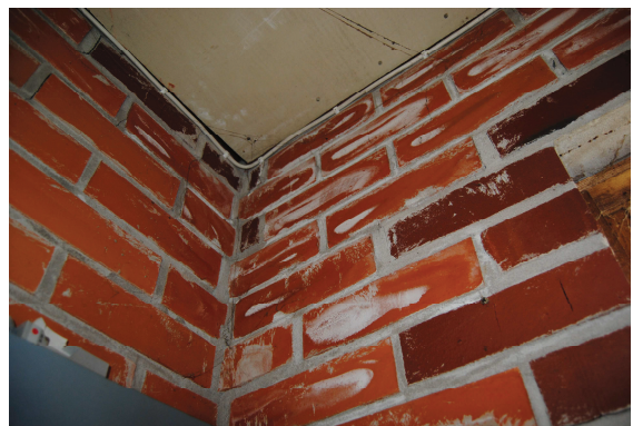
Kosteutta ulkoseinän sisäpinnassa, talo A
