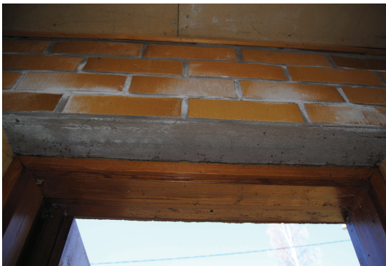
Kosteutta ulkoseinän sisäpinnassa, talo B
