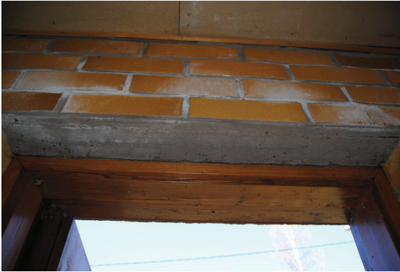
Kosteutta ulkoseinän sisäpinnassa, talo B
