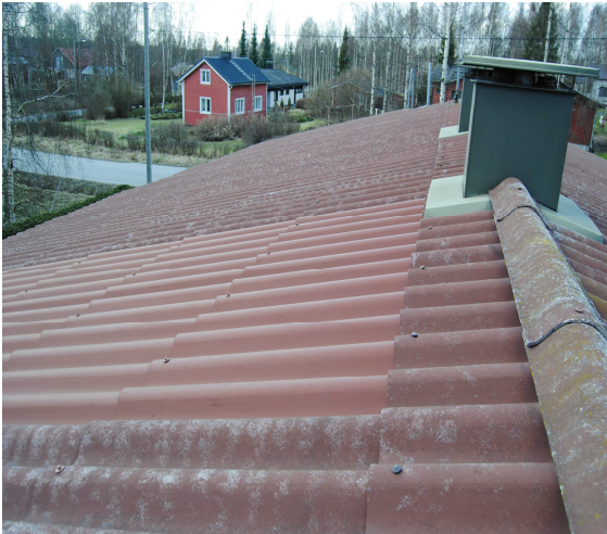
Talo A:n vesikatto ja vaihdettuja levyjä
