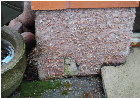
Sokkelin pinnoitteen halkeamia
