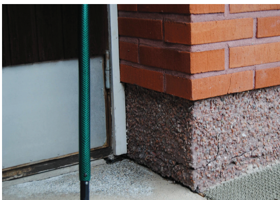
Kosteutta rakennuksen sokkeleissa
