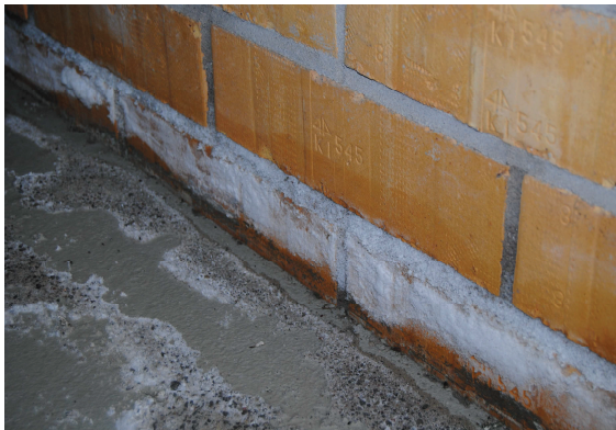
Kosteutta seinän ja lattian rajassa
