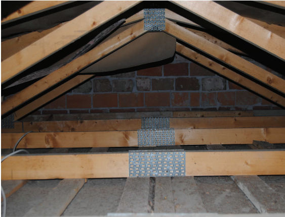
Aluskate pois paikoiltaan, talo A:n autotalli
