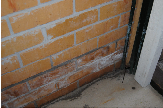
Kosteutta myös autotallien ja varastojen sisäpuolisissa rakenteissa
