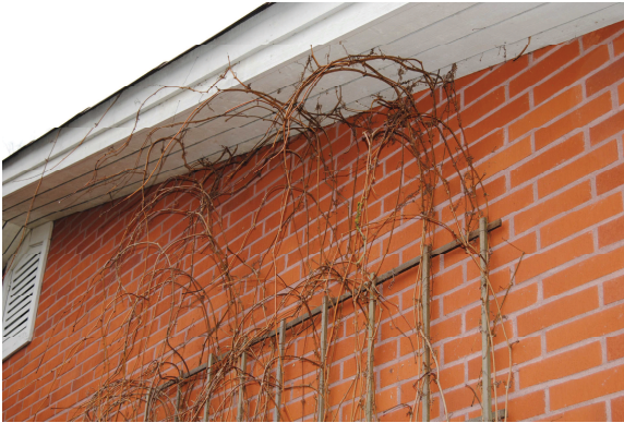
Köynnöskasvi tunkeutuu räystäsrakenteisiin
