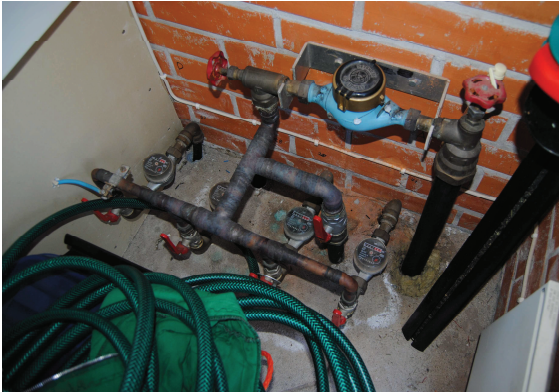
Tekninen tila talo A, vedenjako
