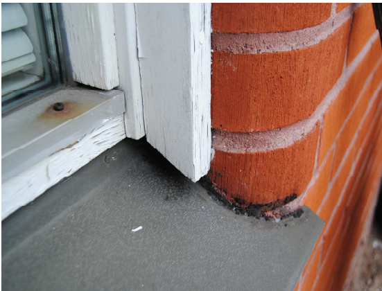
Ikkunoiden vesipellin tiivistys hapertunut
