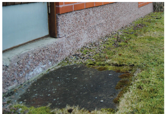
Teknisen tilan porraslaatta
