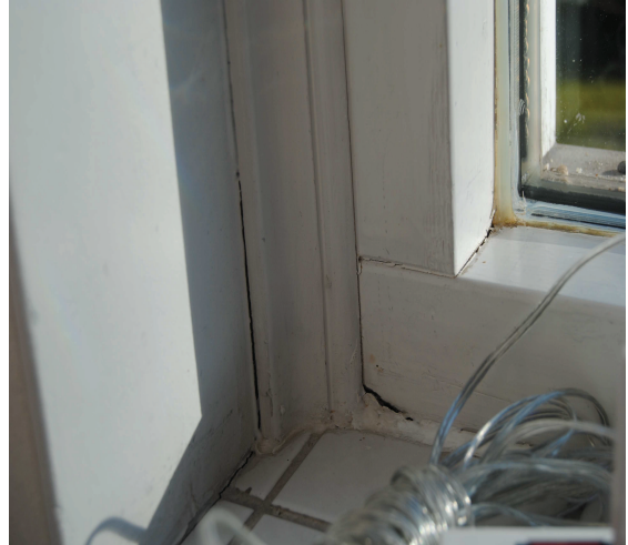
Rakoja ja halkeamia ikkunan ja ympäröivien rakenteiden liittymissä
