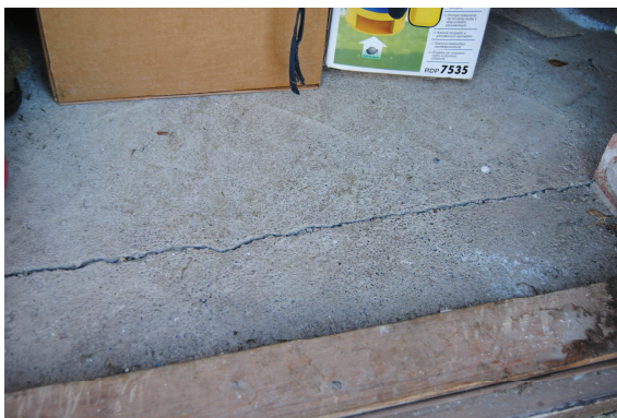
Talo A:n teknisen tilan lattiassa halkeama
