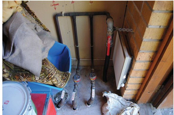
Tekninen tila talo B, vedenjako
