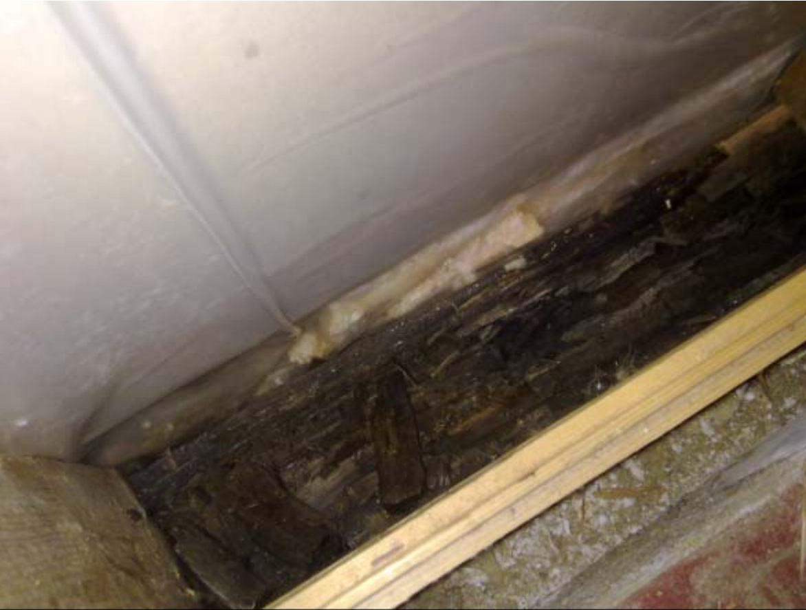
Kuva 4. Lahonneita alapuita kylmähuoneessa.
