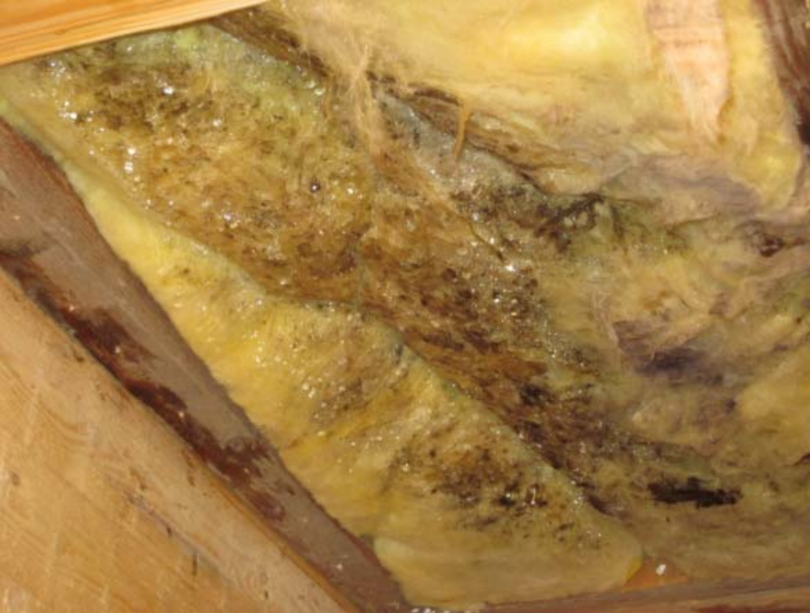
Kuva 3. Jäätä kylmähuoneen katon villaeristeessä
