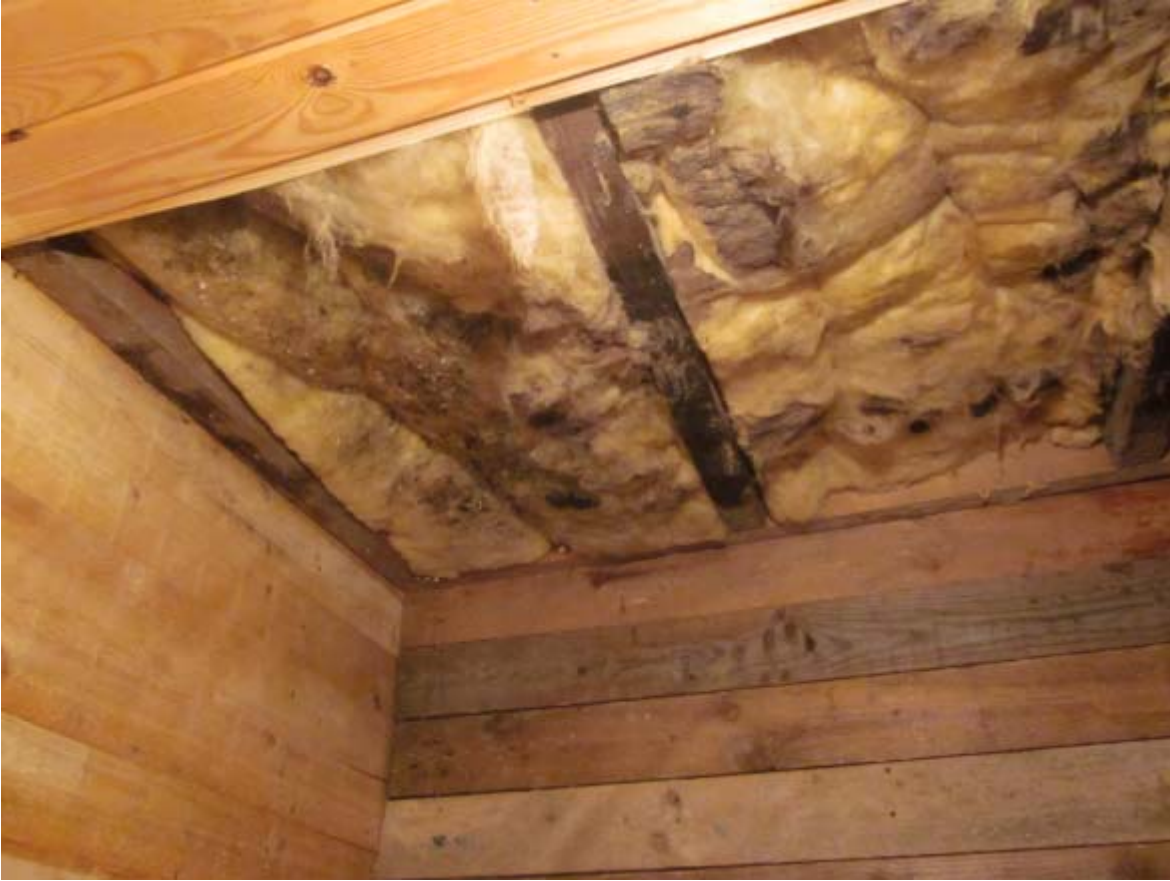
Kuva 2. Mustuneita ja läpimärkiä villoja kylmähuoneen katossa.
