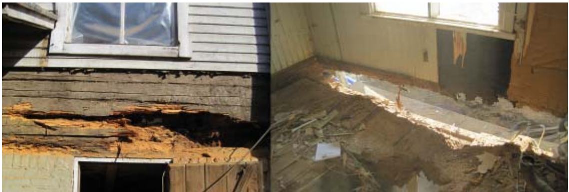
KUVA 23. Vaurioitunut hirsirakenne kuvattuna ulkoa ja hieman myöhemmin sisäpuolelta. Kyseisessä tilassa korjattiin myös koko välipohja.
