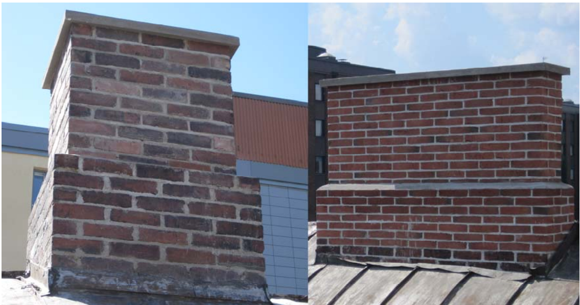
KUVA 29. Uudelleen muurattuja savupiippuja. Vasemman puoleisessa käytetty purkutiiliä ja oikean puoleisessa korvaustiiliä. Piippujen alaosat ja betonihatut pellitettiin piiloon kattotyön yhteydessä.
