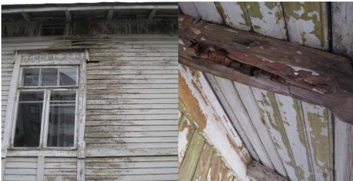
KUVA 26. Puukerroksen vaurioituneita rakenteita.
