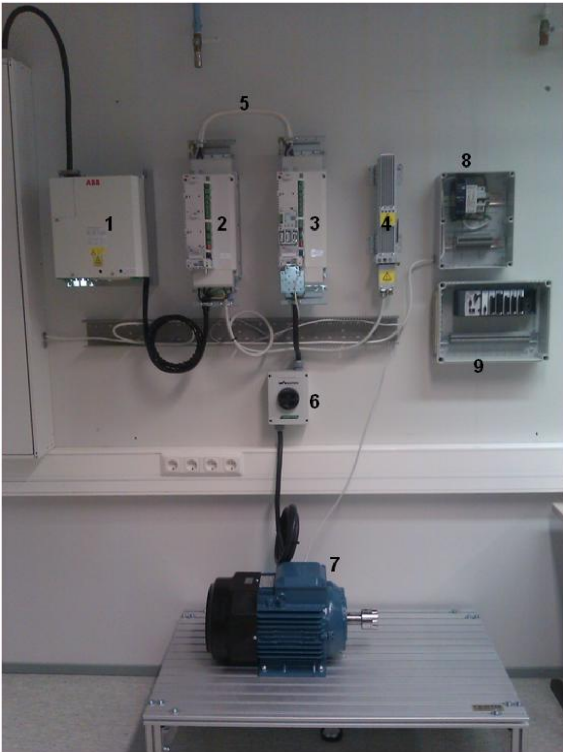
KUVIO 24 Sähköasennukset, Suodatinyksikkö (1), Vaihto/tasasuuntaaja (2), Taajuusmuuttaja (3), Jarruvastus (4), DC-välipiiri (5), Turvakytkin (6), 7,5 kW induktiomoottori (7), DC-jännitelähteet (8), I/O-moduuli (9)
