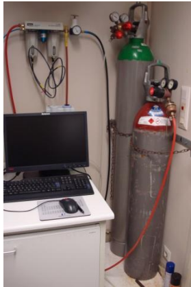
Kuva 10. Esimerkki kaasujen sijoittamisesta AAS -laitteen viereen (Kuva: P.Lehtonen)
