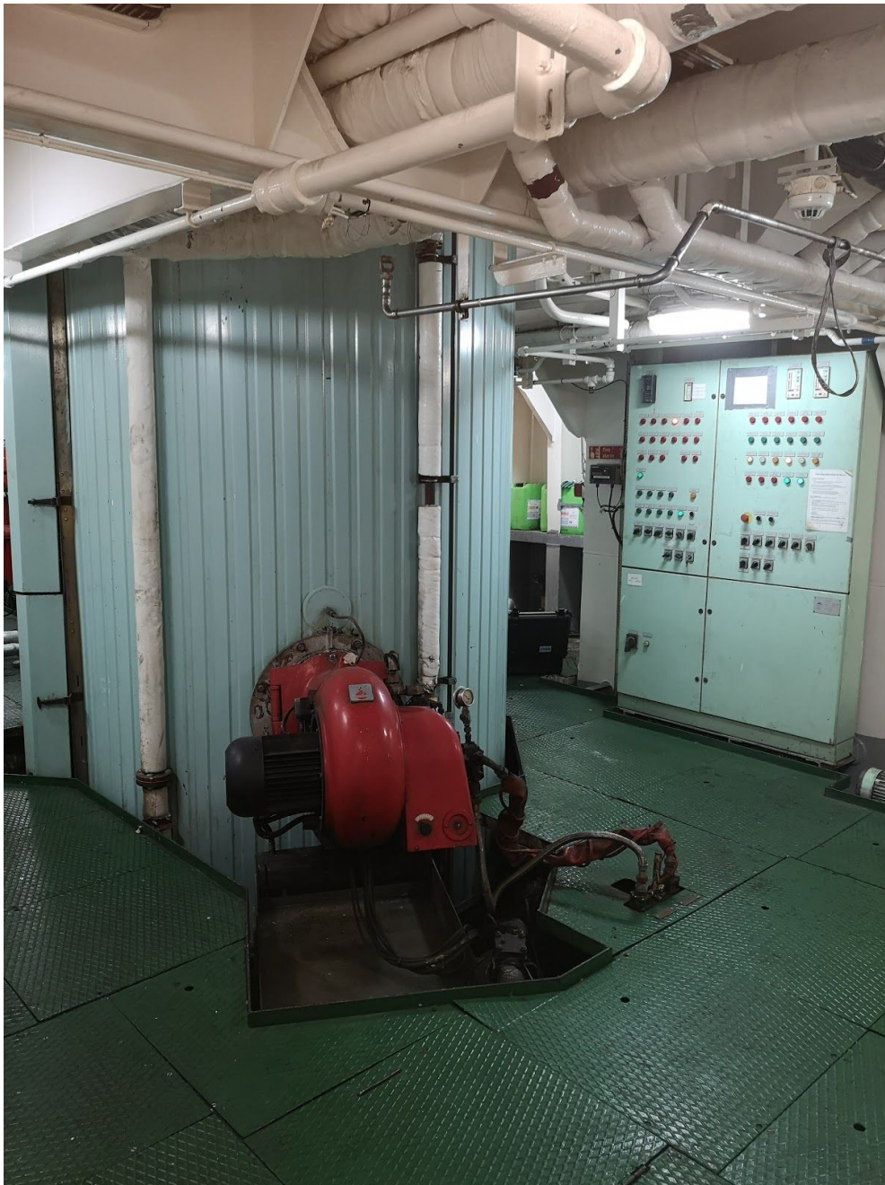
Figur 18. Panna och brännare med kontrollpanelen till höger. Från Finbo Cargo.
