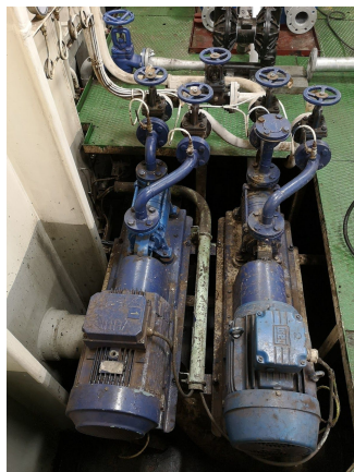
Figur 17. De befintliga matarvattenpumparna på Finbo Cargo.
