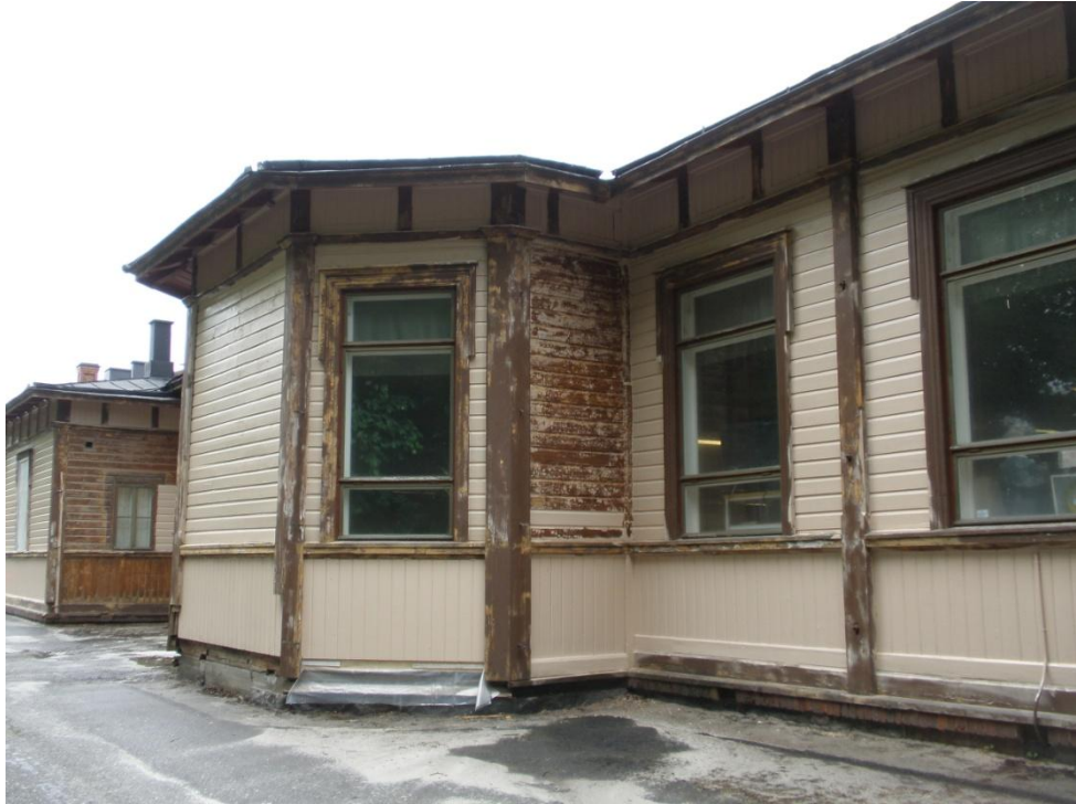
Kuva 14. Pohjoisjulkisivun 5-kulmainen erkkeri. Osa paneeleista on jo pohjamaalattu, osaa vanhasta maalipinnasta jouduttiin pinnan epätasaisuuden vuoksi poistamaan hiekkapuhalluksen lisäksi myös infrapunalämmittimellä.
