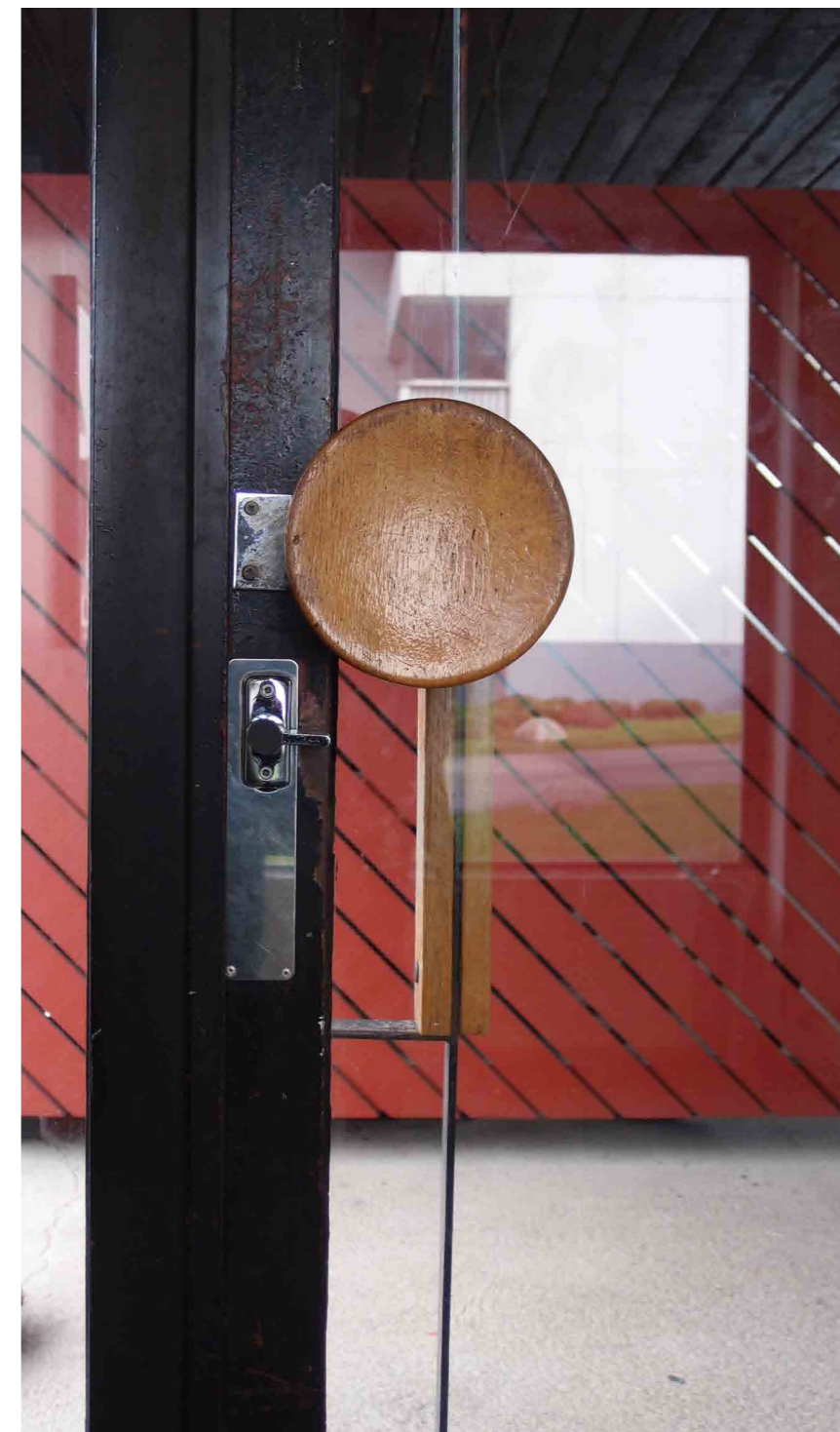
Opinnäytetyöntekijän kerrostalokodin ulko-ovi porrashuoneesta kuvattuna. Ovi on alkuperäisessä kunnossa vuodelta 1970. Kerrostalon on suunnitellut arkkitehti Touko Neronen.
