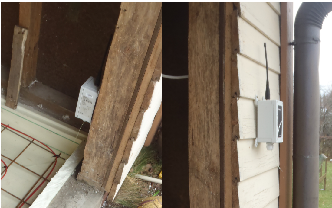
Kuva 15. Betonivalun ja ulkoilman lämpötilaa mittaavat lähettimet.
