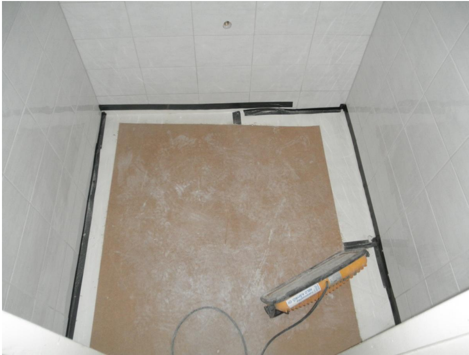
Kuva 12 Kylpyhuoneen suojaus (Heikki Hannikainen)
