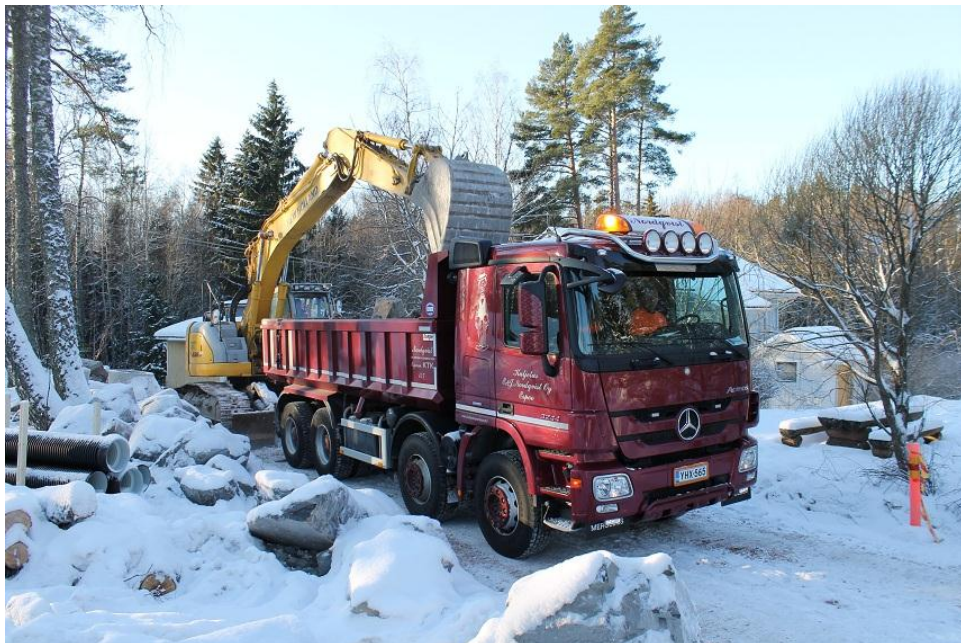
Kuva 3. Kuorma- ja maansiirtoautoja käytetään Kiuastien työmaalla. Kuorma- ja maansiirtoautoista on 4-akselisia maansiirtoautoja. Kuva: Pasi Heiskanen
