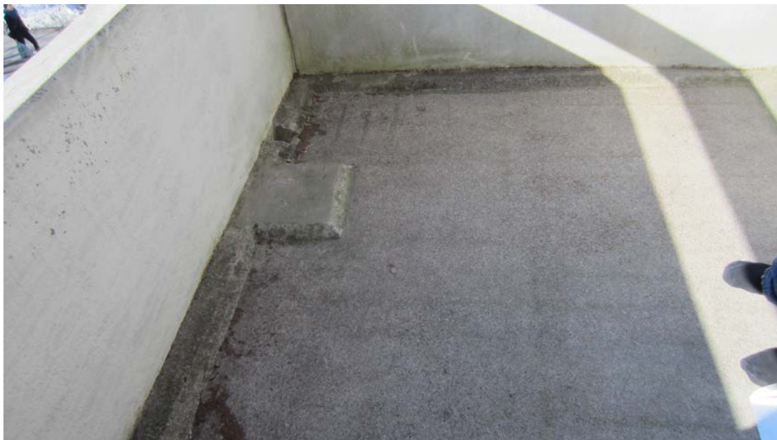
Kuva 2. Parvekkeen lattiassa sammalta.
