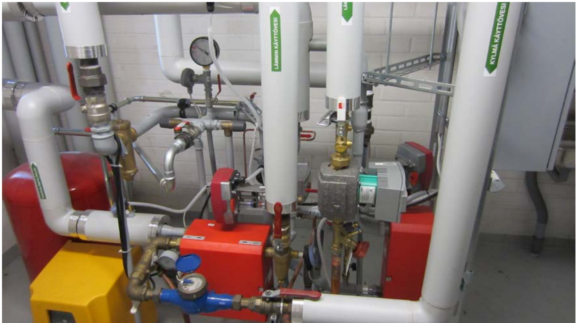
Kuva 5. Lämmönjakuhuoneen uusitut kaukolämpölaitteet.
