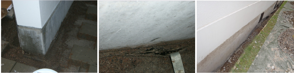
Kuva 5. Huonosti asennettuja vedeneristeitä [11.]
