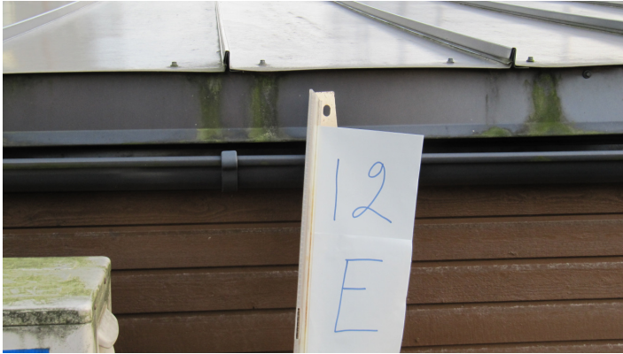
Kuva 14. Epätiivin pellityksen aiheuttama vuoto. [11.]
