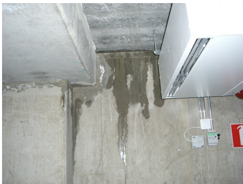
Kuva 6. Puutteellisen vedeneristyksen aiheuttama vuoto kellaritiloihin [11.]
