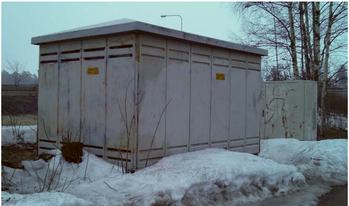
Kuva 3. Puistomuuntamolle suoritettu kiinteistönhoito (13.4.2013)
