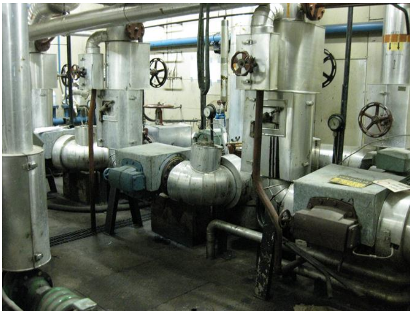
Kuva 2. Öljyn pumppaukseen liittyviä putkistoja
