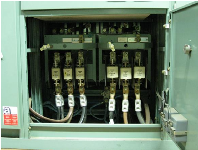
Kuva 6. Keskuksista 1CA syöttö keskukselle 1DG, oikeanpuoleinen lähtö
