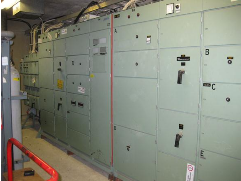
Kuva 1. Öljyaseman yläkerran sähkökeskushuone
