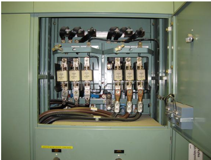
Kuva 7. Keskuksista 1CB syöttö keskukselle 1DH, oikeanpuoleinen lähtö
