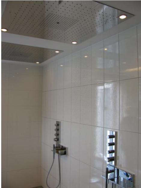
Kuva 37. Piiloasennettu kattosuihku (Kuva: tekijän 2012).
