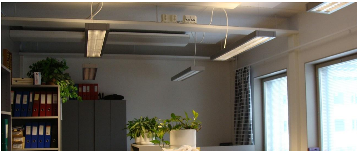
Kuva 35. Toimisto G3-30 ja G3-31 valojen ollessa toisessa päässä sammuneina
