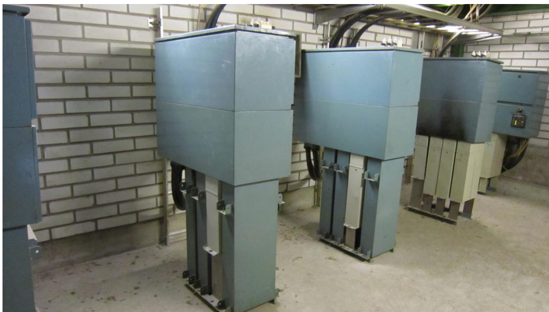
KUVA 16. Kondensaattoriparistoja asennettuna erilliseen kuivaan tilaan
