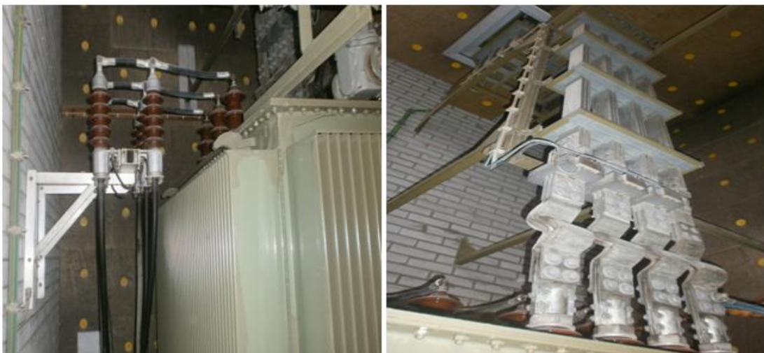
KUVA 5. Muuntajan yläjännitepuoli (20 kV) vasemmalla ja alajännitepuoli (0,69 kV) oikealla
