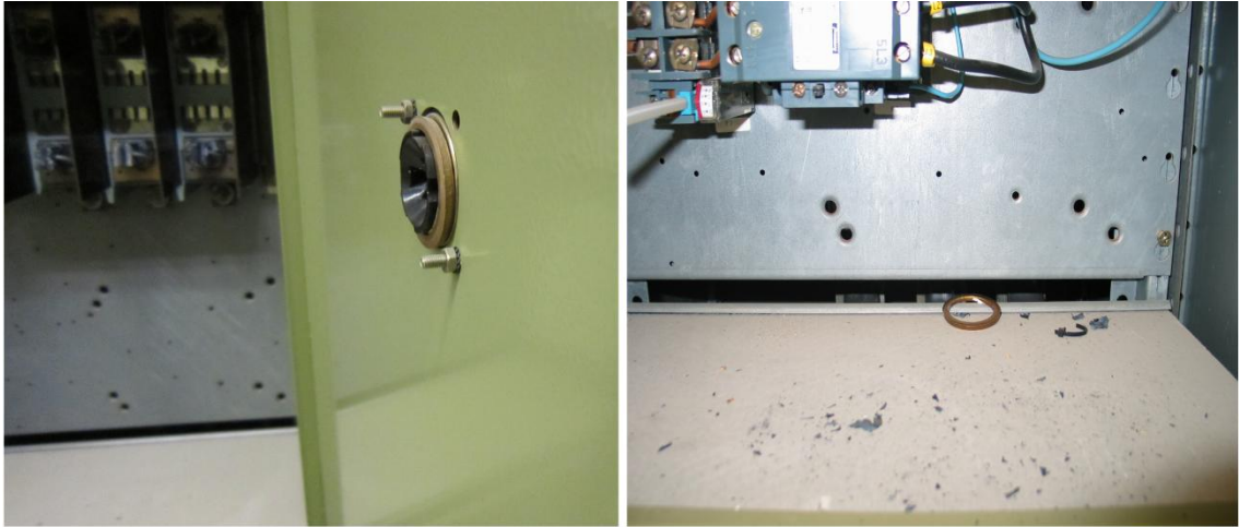
KUVA 18. Väänninkahvan lukitusrikka ovesa ja lähtökennon pohjalla
