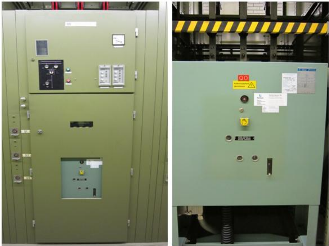
KUVA 13. Suurjännitekojeistossa oleva vähäöljykatkaisija (OSAN 24 A1)
