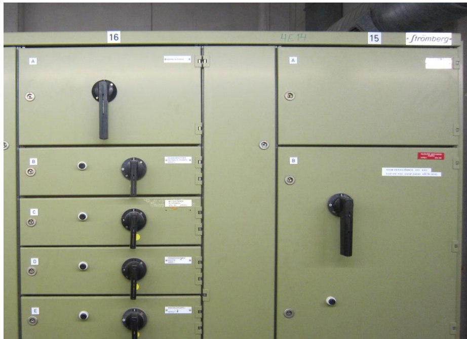
KUVA 7. Pääkeskuksen 4E14 lähtökentät 15 ja 16 sekä näiden kentissä olevia kennoja
