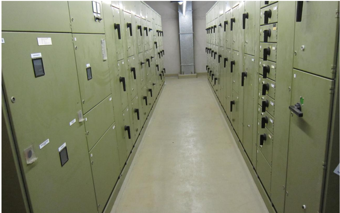
KUVA 8. Sähkötilassa 42 oleva pääkeskus 4E13
