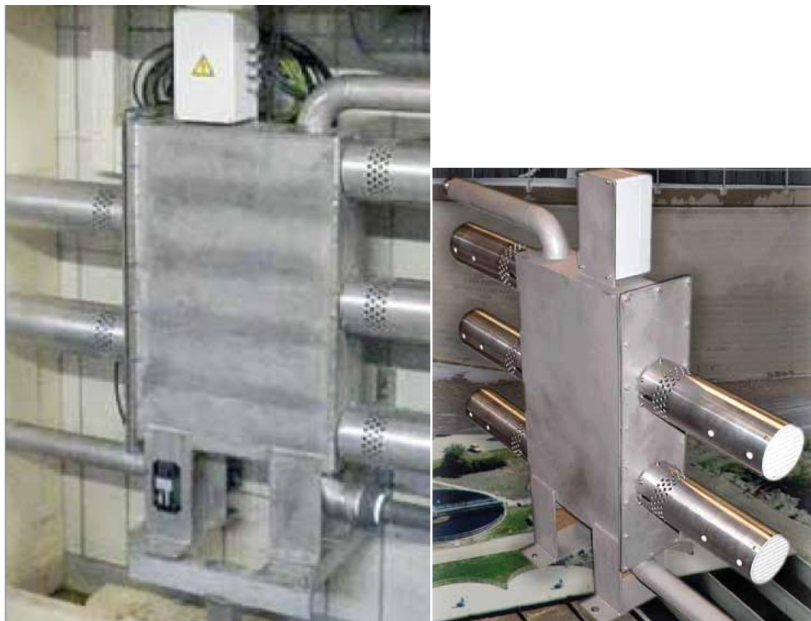
Figur 19. Installerad Sonolyzer-enhet (t.v.) och fristående Sonolyzer-enhet (t.h.). Substratet kommer in via det övre röret, de fem Sonotrode-enheterna på sidorna utsätter det för ultraljud, varefter det fortsätter vidare via det undre röret (Ovivos broschyr för Sonolyzer).
