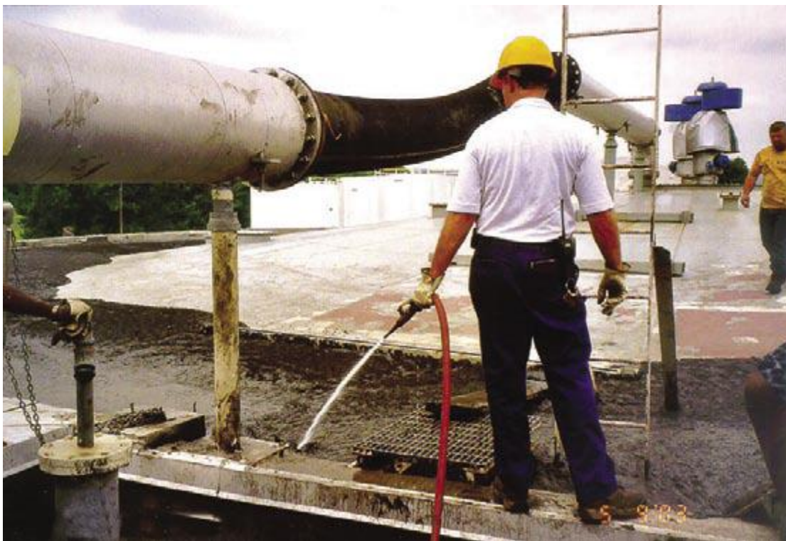
Figur 5. Personal på Morris Forman Wastewater Treatment Plant i Louisville, Kentucky, USA, försöker åtgärda kraftig skumning, som fått röt-kammarens innehåll att stiga upp på taket (Massart, Bates, Corning & Neun, 2006, s. 53).
