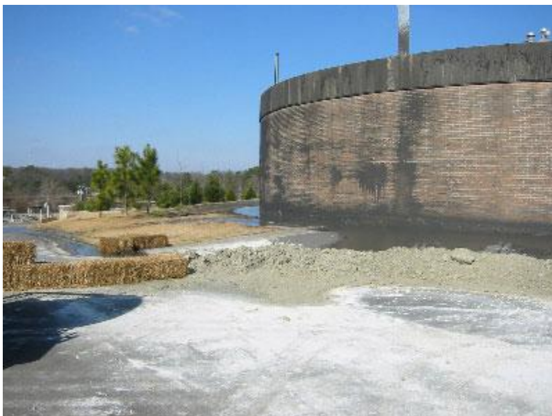
Figur 13. Översvämning av röt-kammare vid vattenreningsanläggning i South Carolina, USA, där slam rinner ut på marken. Kraftig skumning med bl.a. översvämning som följd inträffade flera gånger (Bates m.fl. 2006, s. 10).
