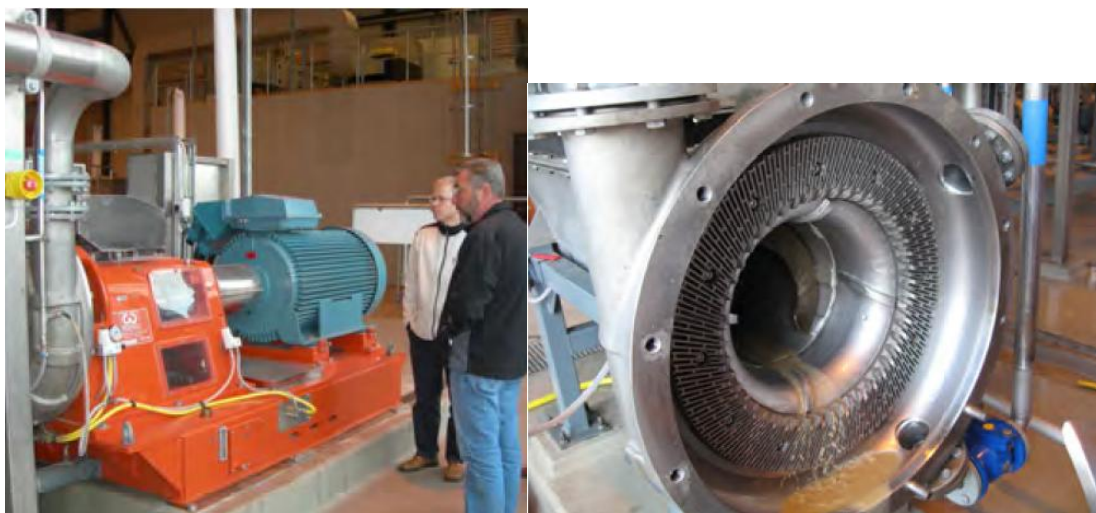
Figur 15. Dispergeringsmaskin vid Jönköpings biogasanläggning. Till vänster hela utrustningen, till höger har malningsutrustningen öppnats så att mittengången med malningsskivor ut med väggarna syns (Hellstedt m.fl. 2010, s. 27).
