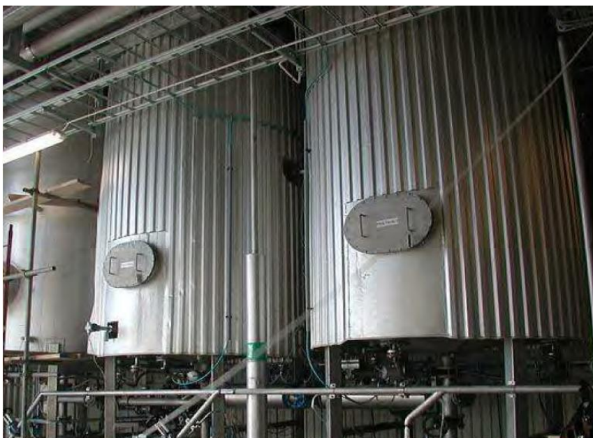
Figur 16. Tre stycken tankar som används för pastörisering vid Uppsala biogasanläggning (Hellstedt m.fl. 2010, s. 29).
