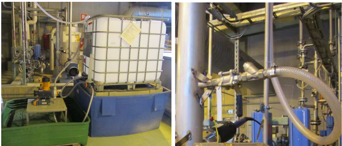
Kuva 7. Annostelulaitteisto ja syöttöyhde imeytysliuoslinjaan
