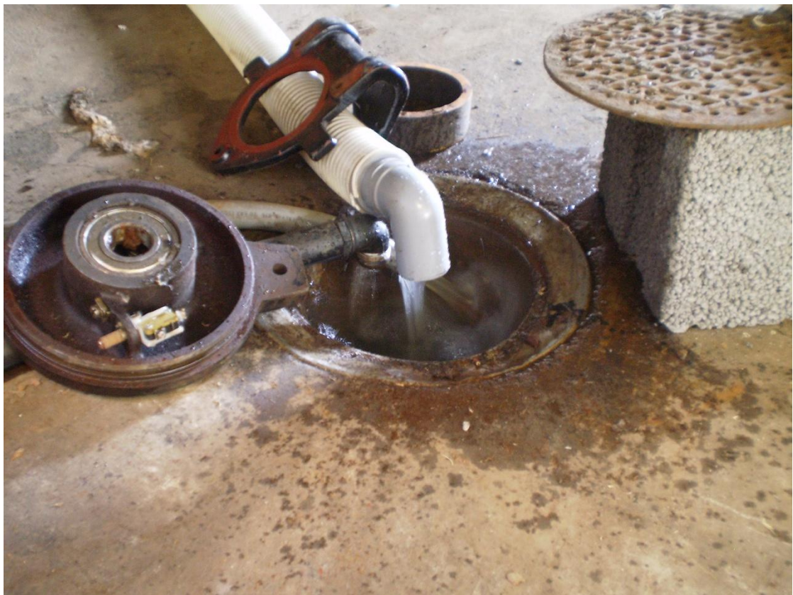
KUVA 8. Lietteen ja puhdistetun jäteveden poistoviemäri. (Mämmelä 2013.)
