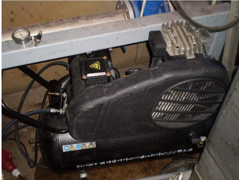
KUVA 9. Kompressorikäynnistyksen yksikkö. (Mämmelä 2013.)
