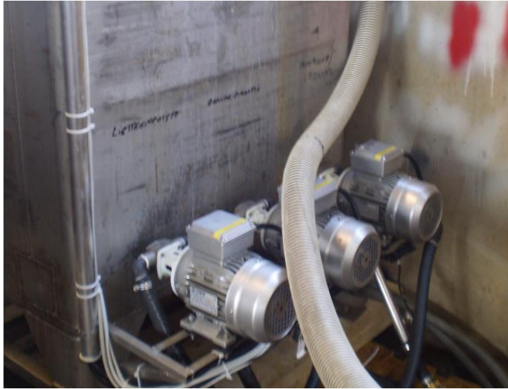
KUVA 6. Lietteenpoisto -, denitrifikaatio – ja palautuslietepumput. (Mämmelä 2013.)
