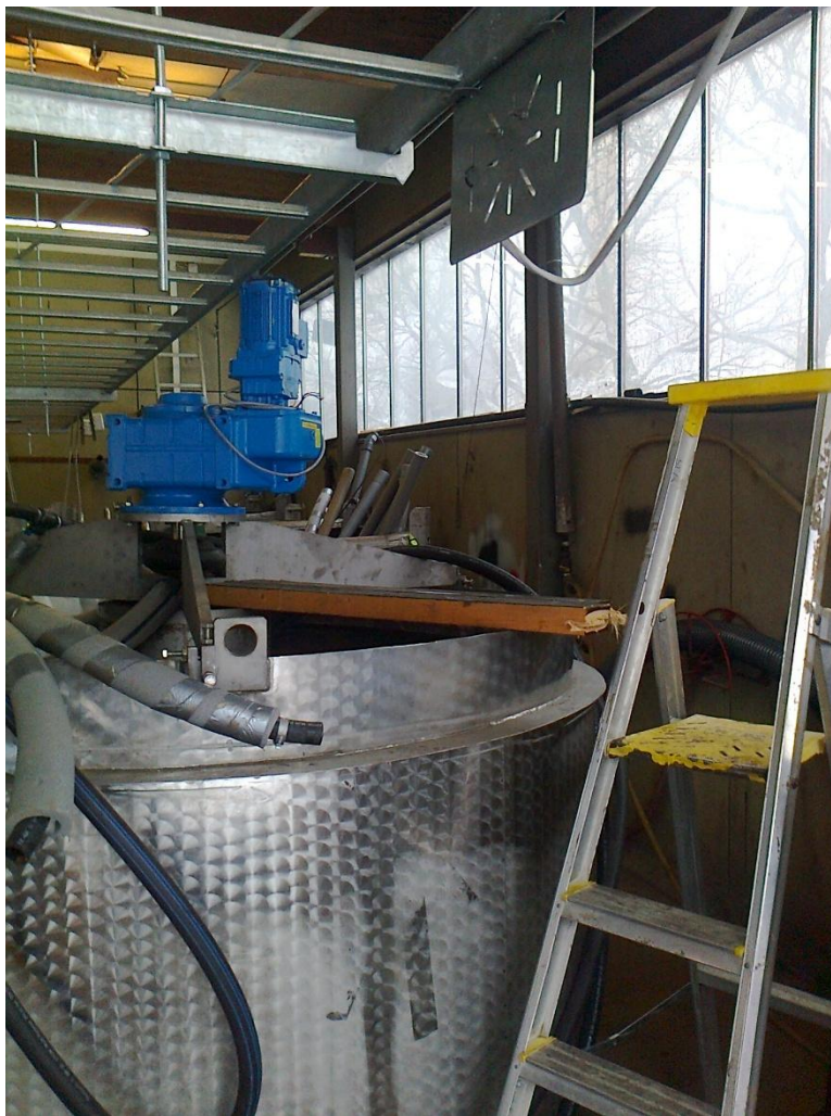
KUVA 15. Jälkiselkeytysaltaan sekoittimen moottori. (Mämmelä 2013.)
