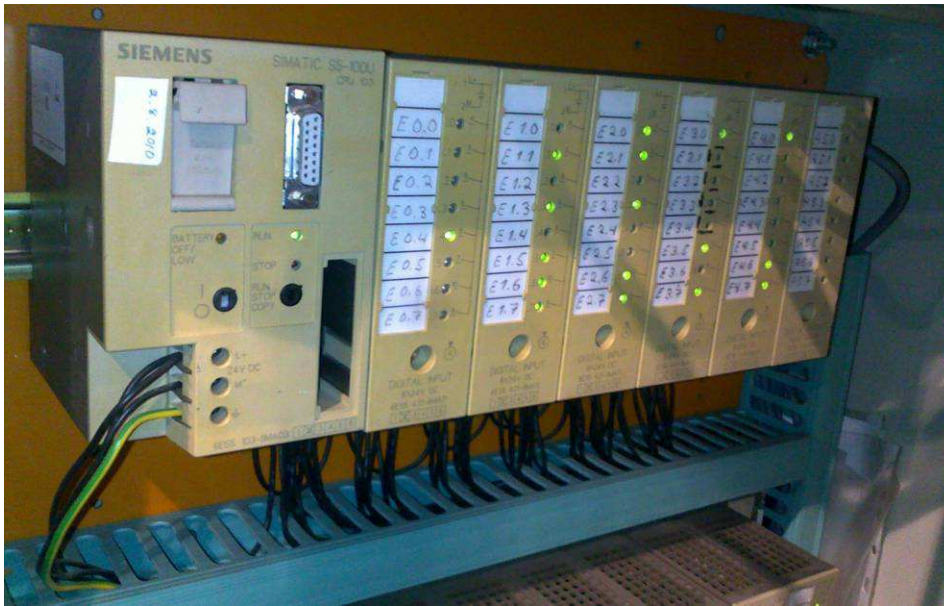
Kuva 13. Asetinrengaskoneen Simatic S5-100U logiikka
