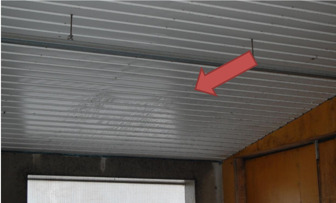
KUVA 12. Emolehmäkasvattamon kattoon tiivistynyttä kosteutta
