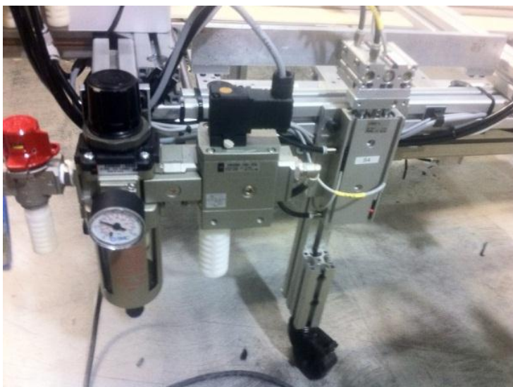
Kuva 19. Paineilman säätö, katkaisu sekä vedenerotin.
