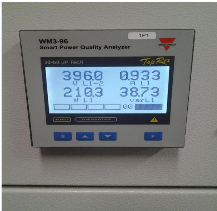
KUVA 6. Keskukseseen asennettava perusmittari nousukeskuksella. Kuva Mikko Karvonen 2013
