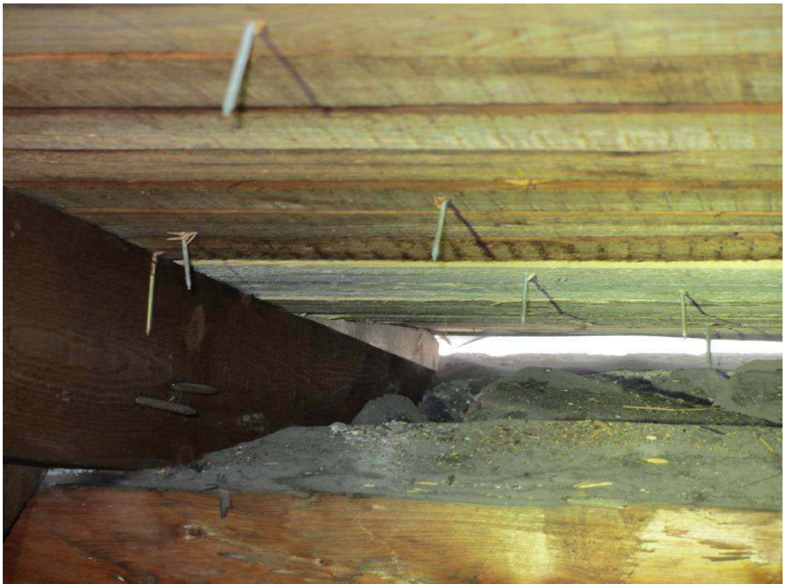
Kuva 18. Alaräystään tuuletukselta parannettu korjauksen yhteydessä [2].
