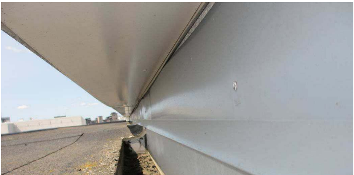
Kuva 17. Tukossa oleva alaräystään tuuletusrako
