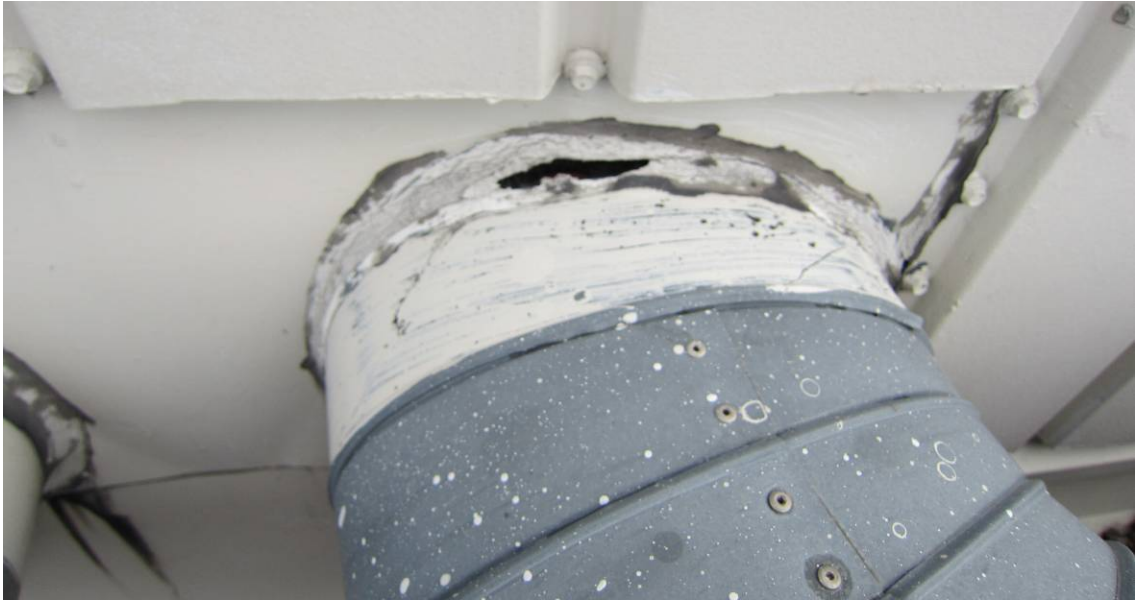
Kuva 14. Ilmanvaihtoputken puutteellinen tiivistys [2].
