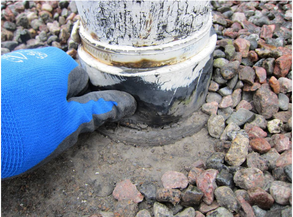
Kuva 13. Vuotava tuuletusputken läpivienti bitumikatolla [2].
