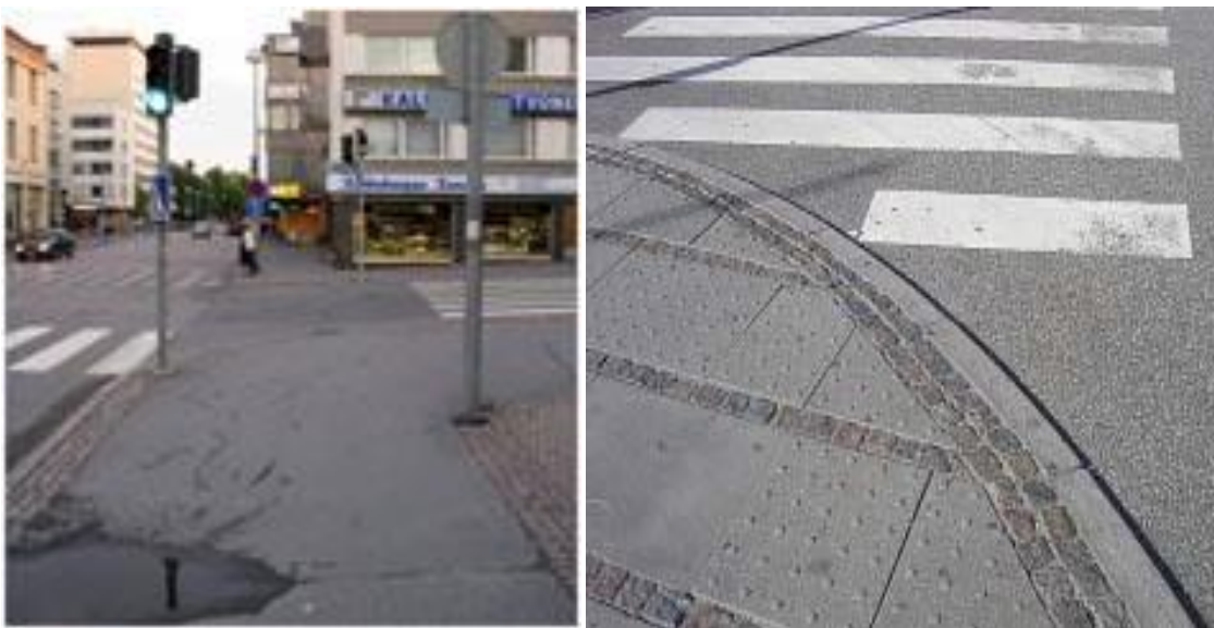
KUVA 42. Suojatien sisennys houkuttelee oikaisemaan suojatien vierestä. Yhdistetyn jalankulku- ja pyörätien reunoilla on reunatunnistinvyöhyke punagraniittisista noppakivistä. Päällysteen tasaisuudessa toivomisen varaa, sillä vesi kertyy lätäköksi (Uusikadun ja Asemakadun liittymä, Oulu)
