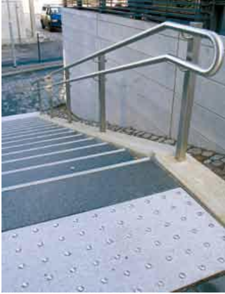
KUVA 17. Erikoistason esteettömissä ulkoportaissa on varoitusalue ennen portaita, selkeät kontrastiraidat askelmien etureunoissa ja oikein mitoitettu käsijohde (Rajapaadenpolun portaat, Vuosaari, Helsinki; Anna Ruskovaara, Ruskovaara ym. 2009)
