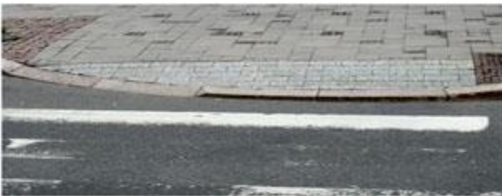
KUVA 44. SuRaKu-ohjeistuksen mukainen esteettömyyden erikoistason jalkakäytävän suojatien reunatukijärjestelmä Kouvolankadulla Kouvossa. Autojen nastarenkaat ovat kuluttaneet maalatut suojatiemerkinnot ajoradasta
