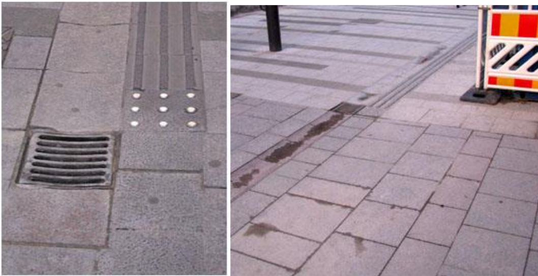
KUVAT 25 ja 26. Kesällä 2013 asennettuja ura- ja huomiolaattoja sekä laakea vesikouru kävelykatu Rotuaarin pinnoitteessa (Kauppurienkatu, Oulu)
