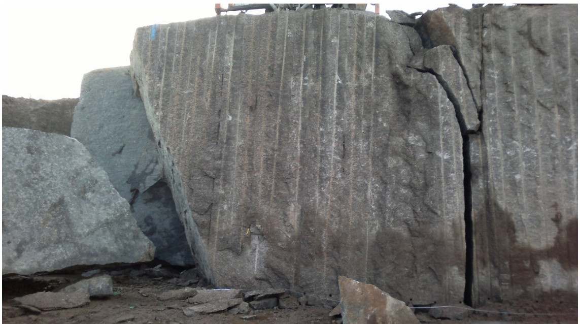
Kuva 4 . Kamin alkupäästä on irronnut lohcare (noin 3x3 m) rakopintoja pitkin. Rakopinnalla oli tummien mineraalien muodostama täyte (kova).
