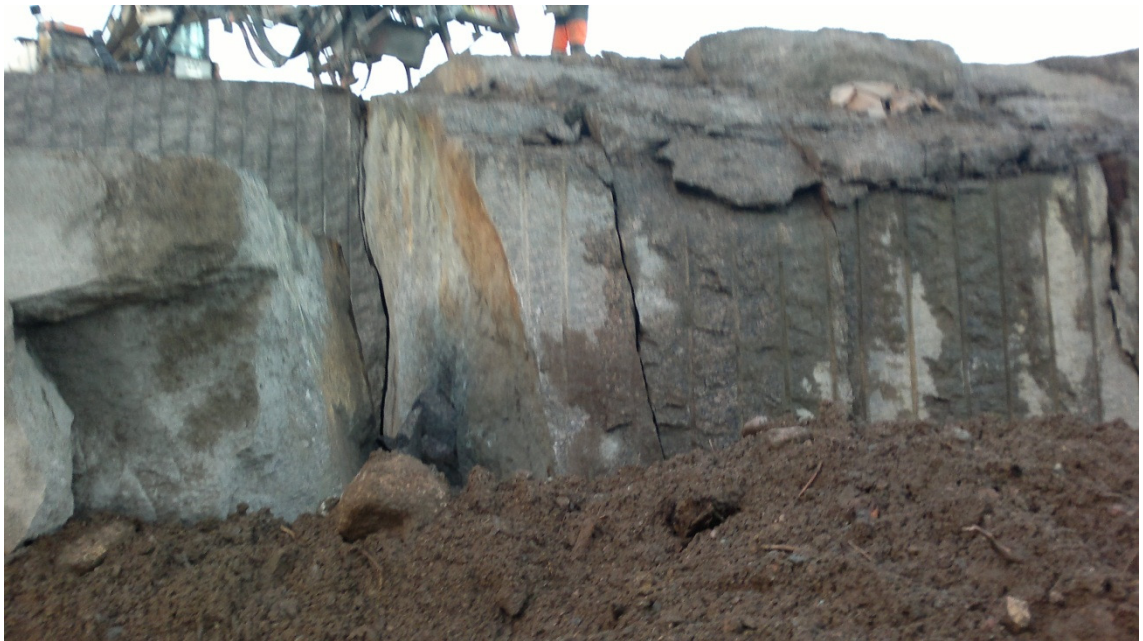
Kuva 20. Kamin poikittaisrako kohdassa 24,6 m, yläreuna on ruosteen värinen.
