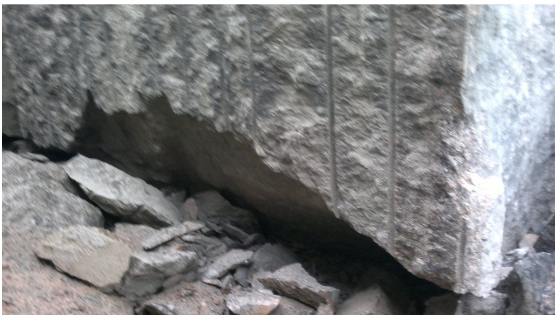
Kuva 11. Kamin takaseinällä lohkeama kohta 8,5 m eteenpäin korkeus noin 0,5 m.
