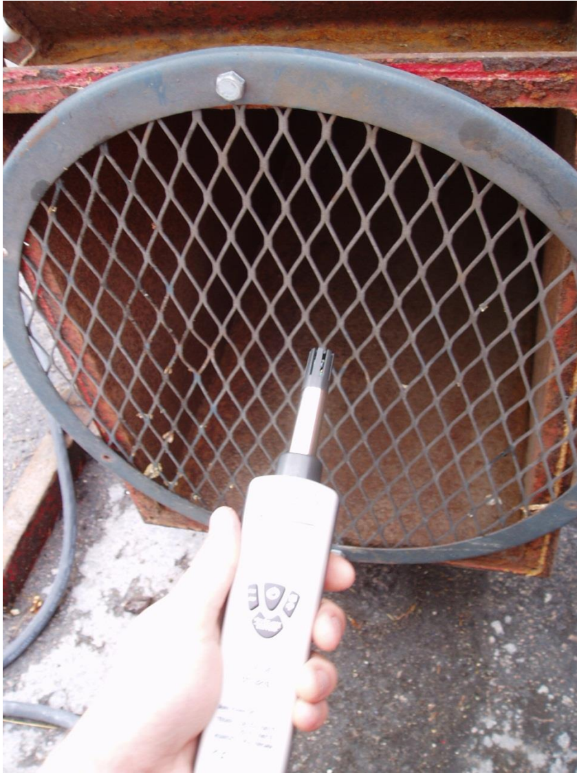
Kuva 7. Ilman lämpötilan ja suhteellisen kosteuden mittausta digitaalisella mittarilla puhaltimen ulostuloilmasta
