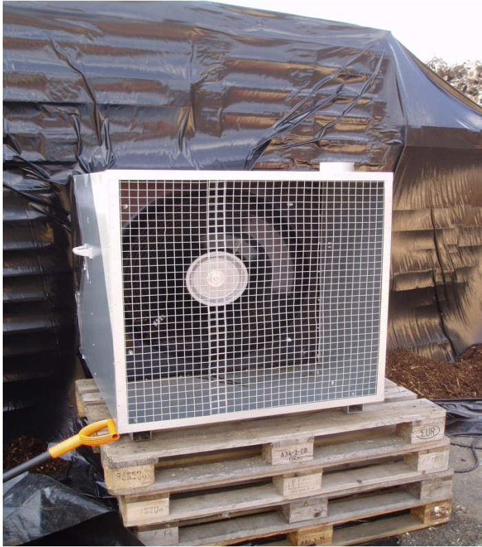
Kuva 6. Toisen kuivausauman puhallin toiminnassa
