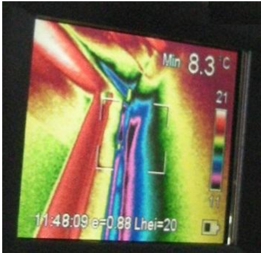
KUVIO 15. Makuuhuoneen ikkunan viereisen seinän lämpövuoto ulkonurkassa.
