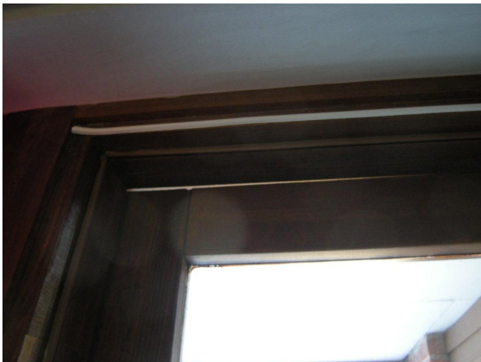
KUVIO 19. Parvekkeen ulko-oven yläreunassa on ilmavuoto, kuvattu samasta kohdasta kuin KUVIO 18.
