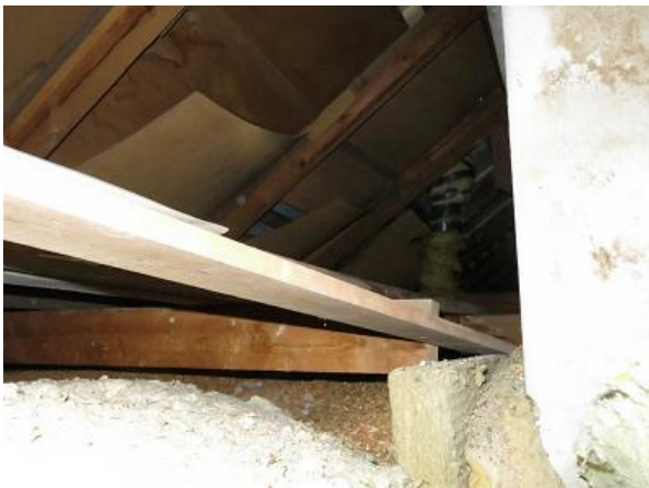
Kuva 9. Aluskate on paikoitellen irronnut, saunan poistoilmaputki on huolimattomasti eristetty.
