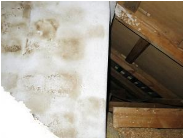
Kuva 8. Piipussa näkyy merkkejä aikaisemmasta kosteusrasituksesta, aluskate on paikoin irronnut.
