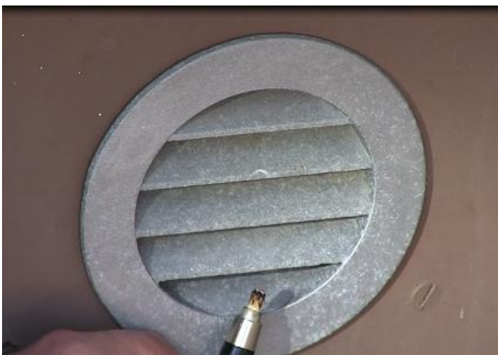
Kuva 15. Savukynän savu imeytyy ulkoa sisään kellarin tuloilmakanavaan
