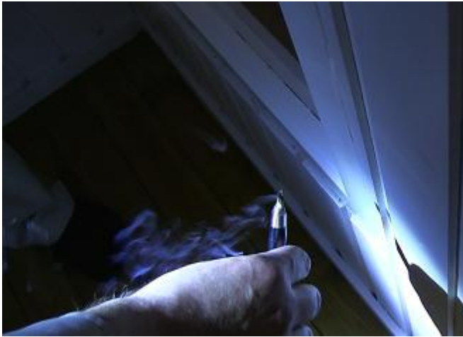
Kuva 13. Kylmän ullakon ja pukuhuoneen väliset ikkunat eivät ole tiiviit
