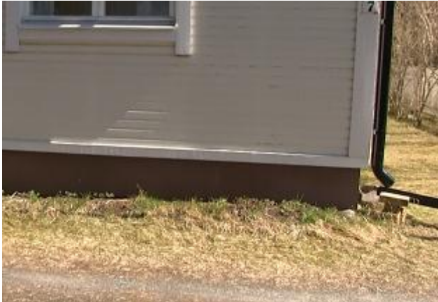
Kuva 1. Maanpinnan kallistukset ovat osittain puutteelliset. Sokkelin vierustalla on kasvillisuutta.
