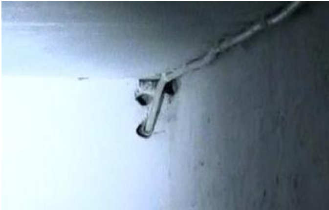
Kuva 16. Sähköjohtojen läpiviennit kellarin seinässä ovat tiivistämättömät
