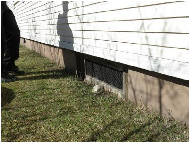
Kuva 4. Maanpinta rakennuksen vieressä viettää eteläseinän tarkastusluukku kohti
