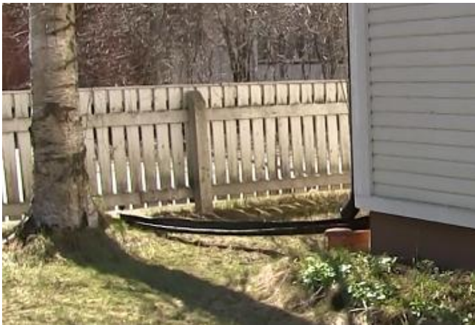
Kuva 2. Maanpinnan kallistukset ovat osittain puutteelliset, samoin sadevesien ohjaus. Sokkelin vierustalla kasvillisuutta.
