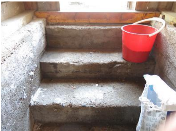
Kuva 14. Kellarin portaat ovat joskus kastuneet
