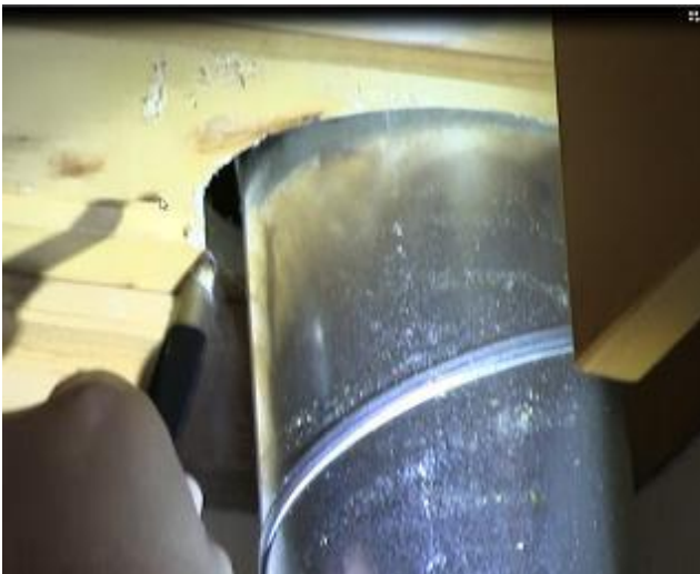
Kuva 11. Viemärin tuuletusputken läpivienti yläpohjassa ei ole ilmatiivis
