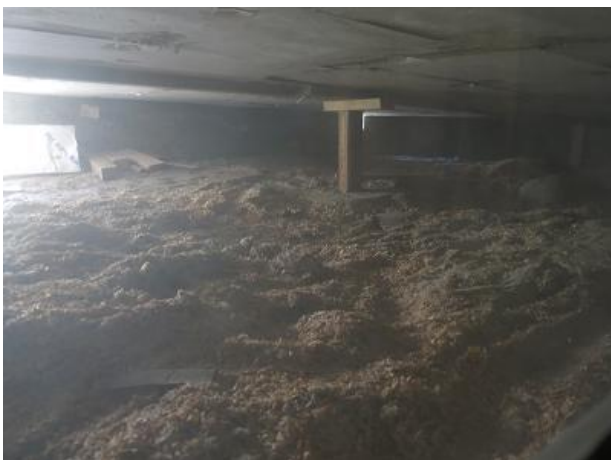
Kuva 3. Ryömintätilassa on roskaa ja rakennusjätettä
