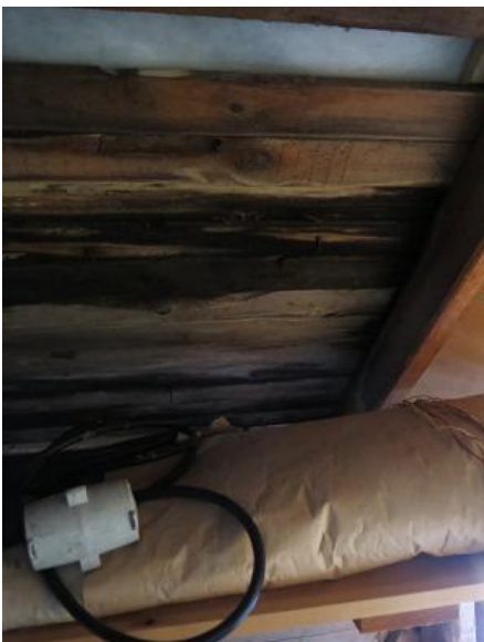
Kuva 6. Yläpohjan rakenteissa näkyy merkkejä aikaisemmasta kosteusrasituksesta
