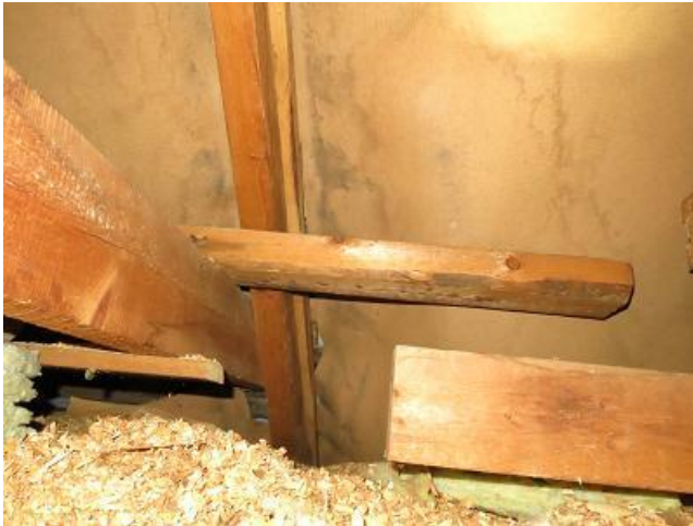
Kuva 7. Yläpohjan rakenteissa näkyy merkkejä aikaisemmasta kosteusrasituksesta. Paikoitellen on mineraalivillan palasia purun päällä.
