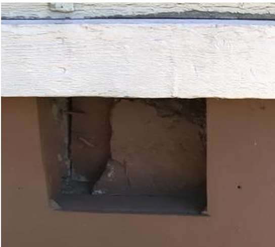
Kuva 5. Ryömintätilan tuuletusaukot ovat osittain tukossa
