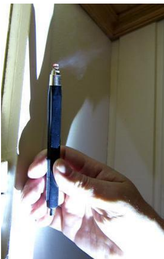
Kuva 12. Kylmälle ullakolle johtavat ovet eivät ole tiiviit
