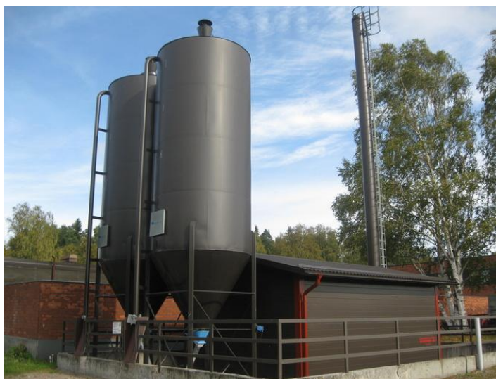
Kuva 4.5 Biofire pellettilämpökontti 600kW
