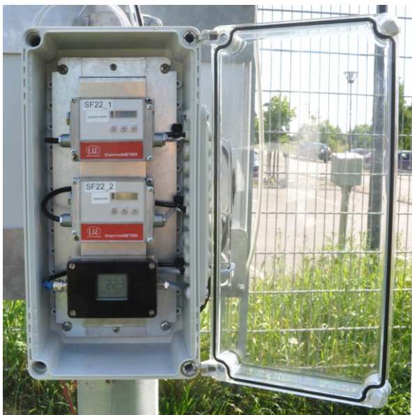
Kuva 13. Elektroniikan kotelointi. Micro-epsilonin (kaksi kappaletta ylhäällä) ja Lumasensin (yksi kappale alhaalla) antureiden elektroniikkaosat asennettiin helposti luettaviksi ja säädettäviksi mittausjärjestelmän viereen tiiviiseen koteloon.
