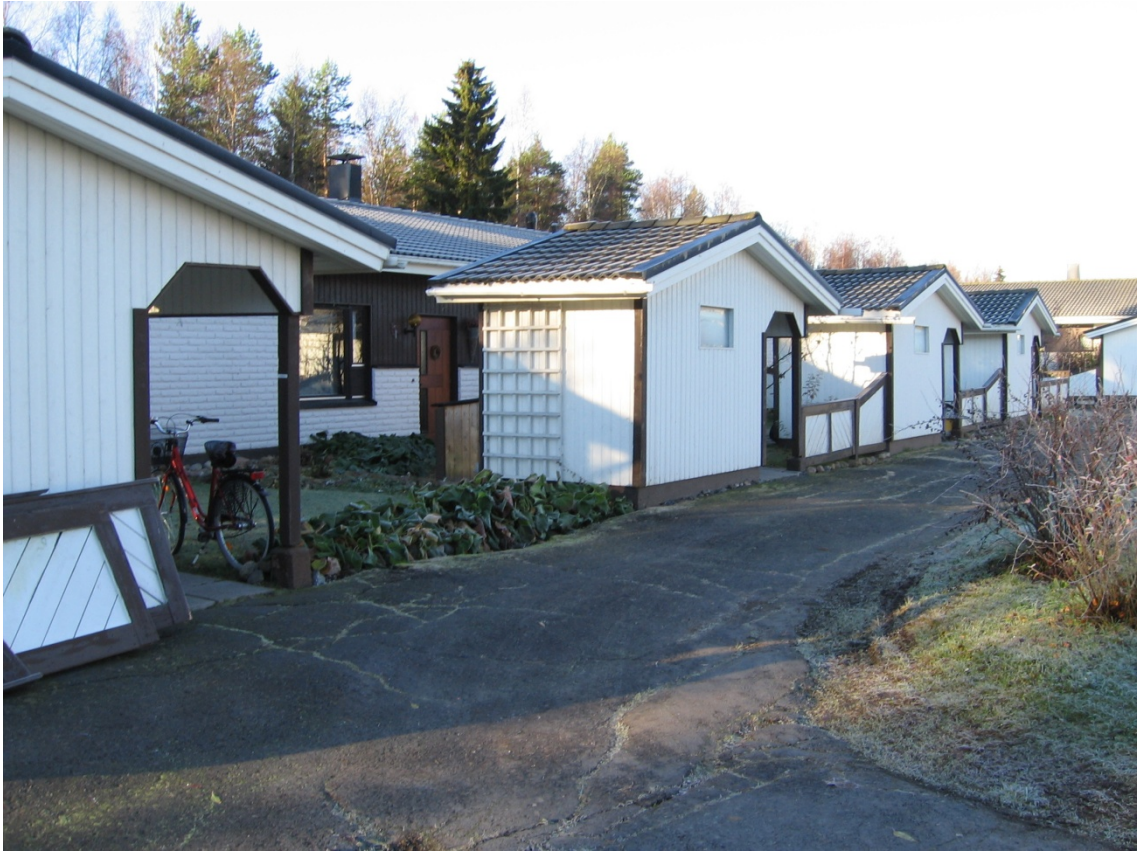
KUVIO 7. Huonokuntoinen asfaltti
