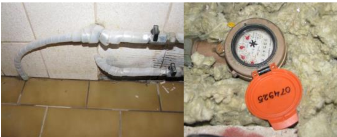
Kuva 21. Vesiputket ovat vanhoja, samoin vesimittari.
