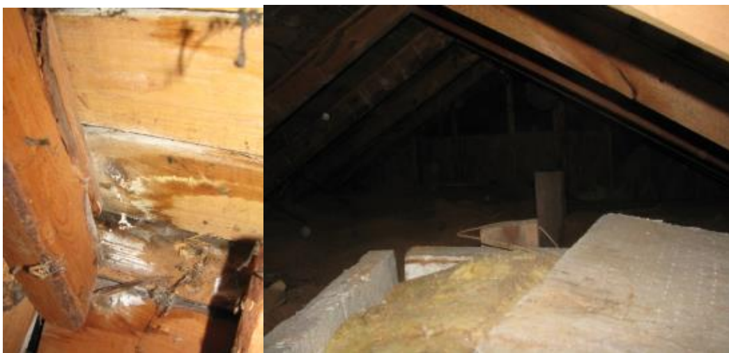
Kuva 13. Vintin vaurioita: vanha kosteusvaurio ja ampiaisenpesä. Etualalla vanha paisuntasäiliö.
