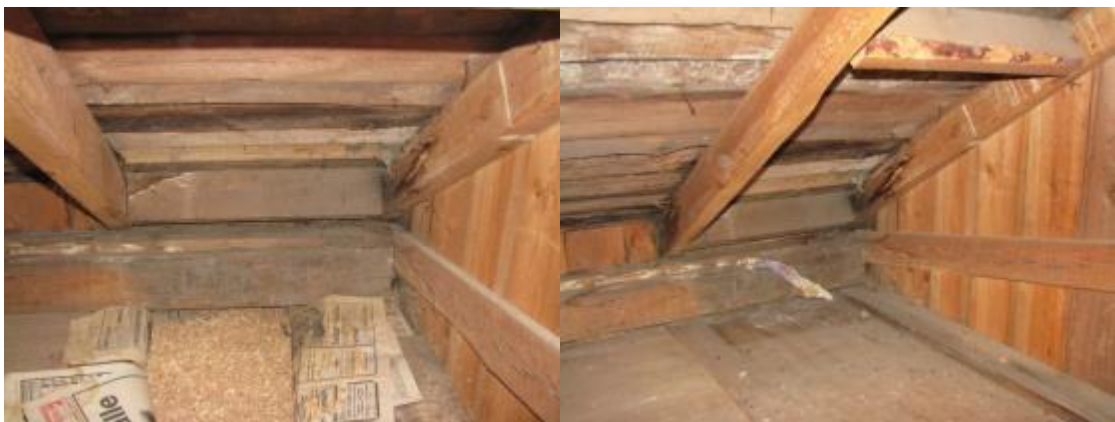
Kuva 14. Kuistin yläpuolisen tilan lounaisnurkassa oli havaittavissa pientä kosteutta.
