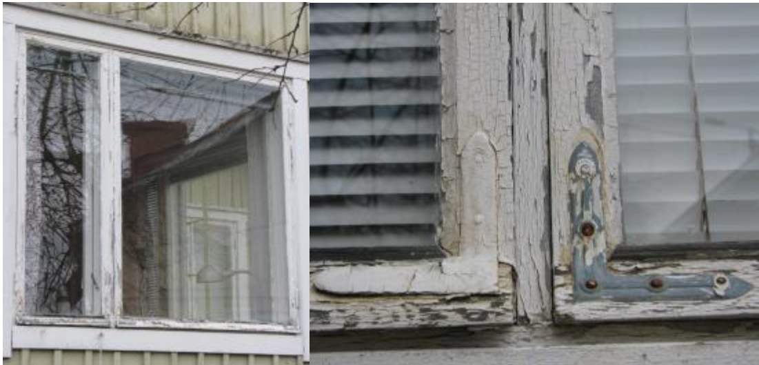
Kuva 10. Ikkunat ovat kiireisen kunnostuksen tarpeessa
