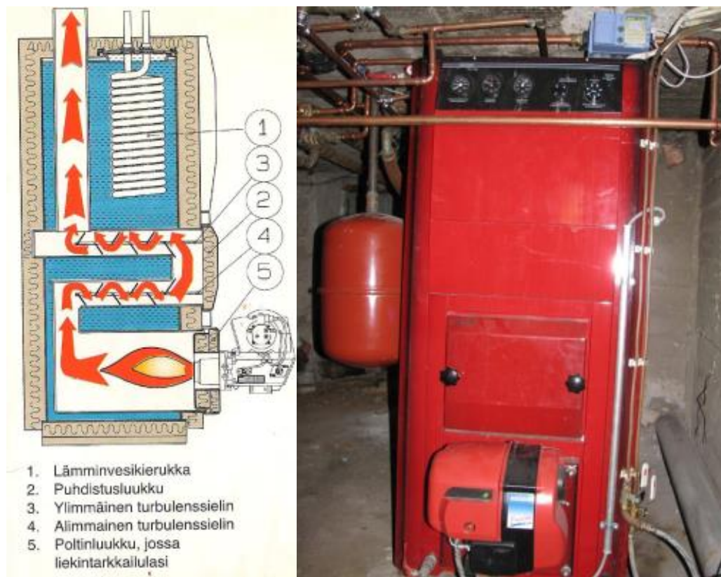
Kuva 19. Öljykattila sijaitsee kellarin pannuhuoneessa.
