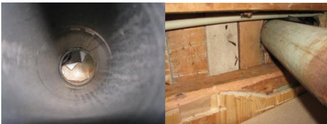
Kuva 16. Viemäreiden tuuletusputki ei kohtaa läpiviennin kanssa, silti aluskatteen alla oleva laudoitus on kuivaa
