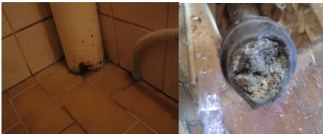
Kuva 20. Viemärit ovat vanhaa valurautaputkea, joka on paikoin aivan tukossa
