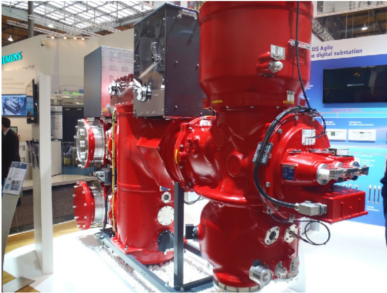
Kuva 4. 110 kV SF-kojeisto luonnollisessa koossaan.
